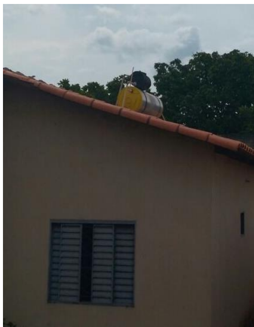
Figura 9 – Sistema de aquecimento de água
