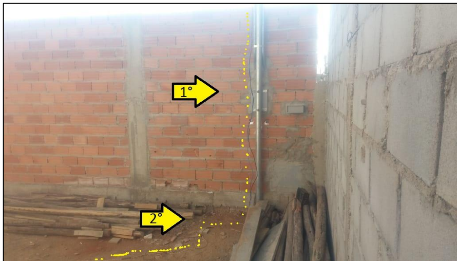
Figura 9 - Cabos elétricos em contato com o solo
