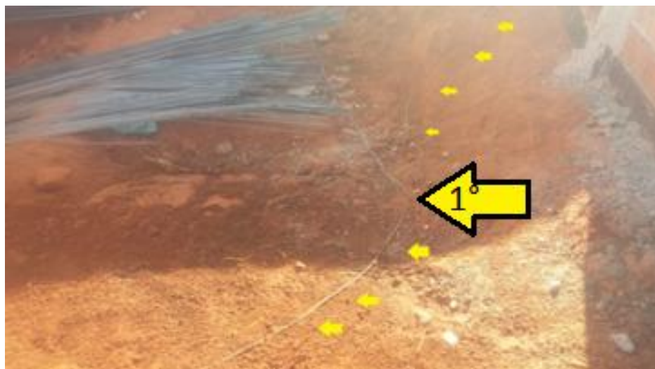
Figura 12 - Cabo elétrico em contato com o solo e material metálico
