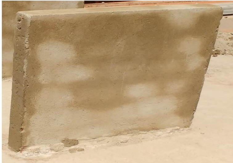
Figura 28 – Parede revestida de argamassa simples
