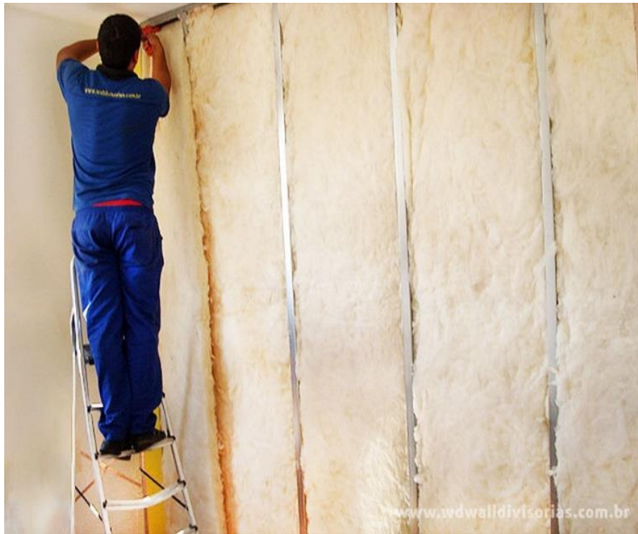
Figura 18 - Lã de vidro em drywall
