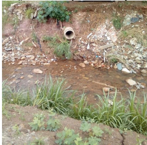
Imagem 8 – Galeria pluvial sem dissipador
