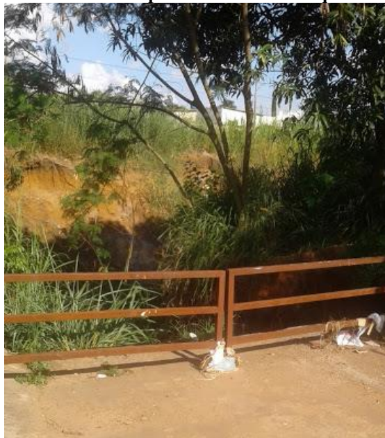
Imagem 19 - Guarda corpo no fim da Rua Joaquim Sebastião.
