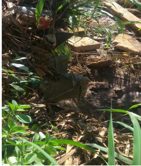
Imagem 7 – Galeria pluvial sem dissipador
