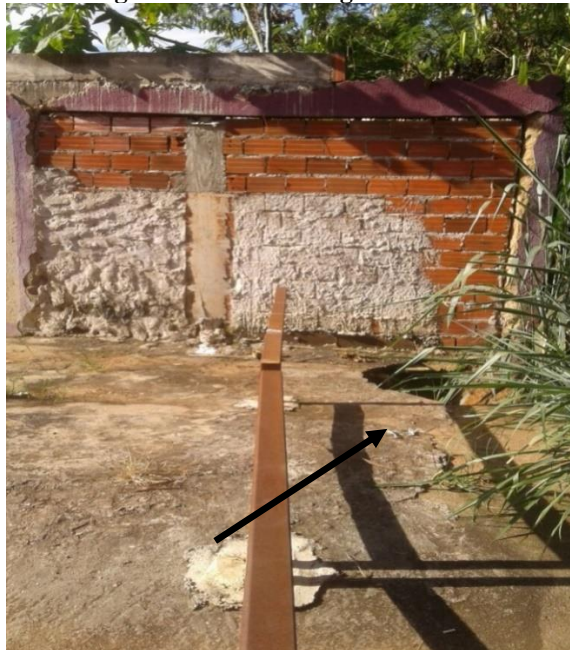
Imagem 4 – Erosão atingindo moradias
