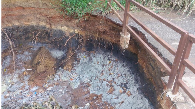
Imagem 20 - Guarda corpo depois da erosão avançar.
