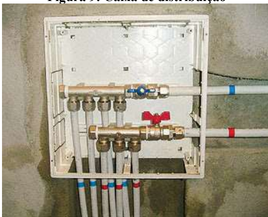
Figura 9: Caixa de distribuição
