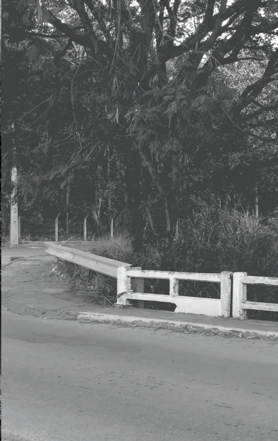
Ponto de alagamento
