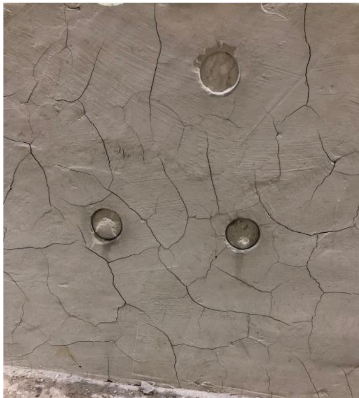
Figura 18- Deslocamento ocorrido na perfuração com serra copo
