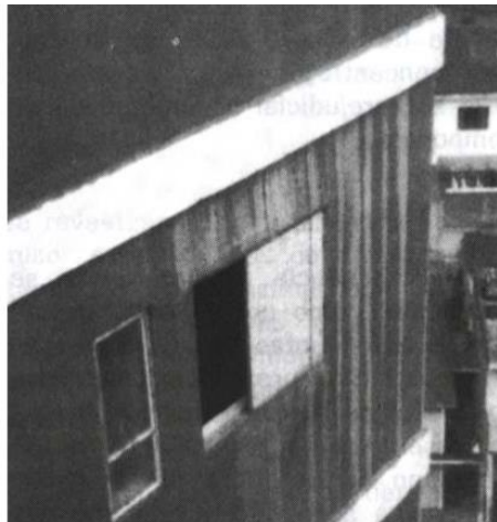
Figura 7- Eflorescência em superfície revestida com argamassa devido à percolação
