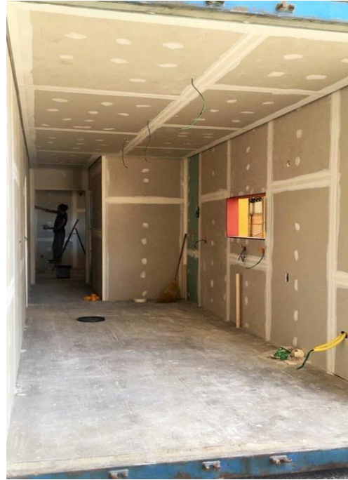
Figura 17 - Instalações elétricas e hidrossanitárias em contêiner
