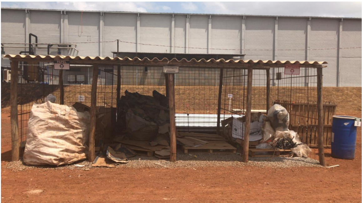
Figura 10 – Resíduos classe B (Obra D)
