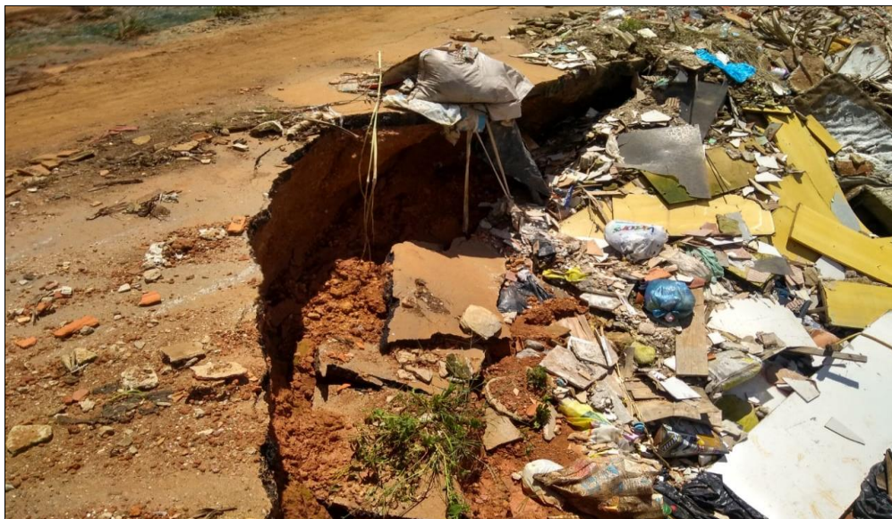
Figura 18 – Lixo despejado na erosão
