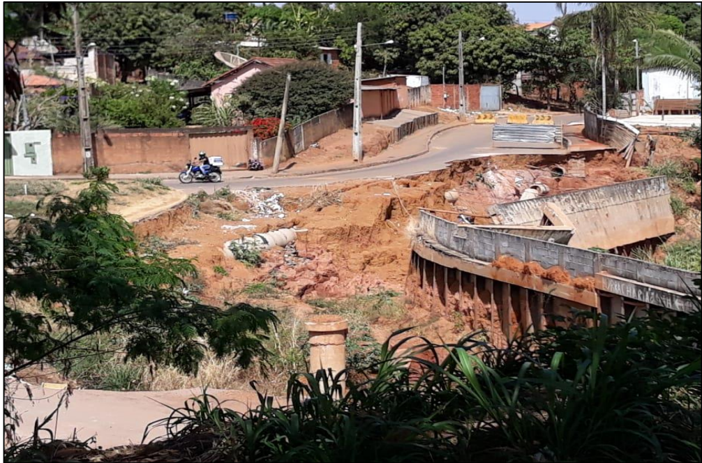
Figura 13 – Erosão na Vila Formosa
