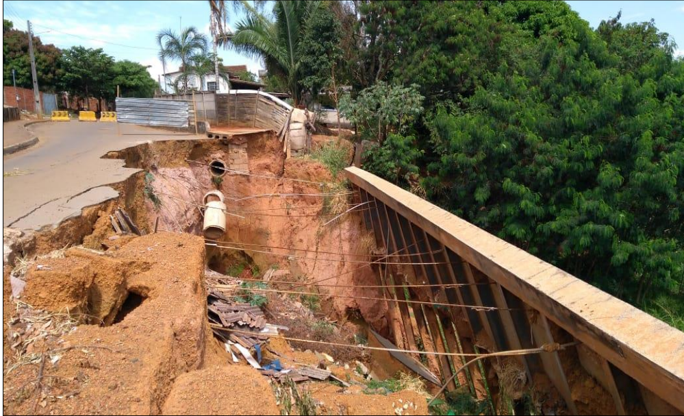
Figura 15 – Estado da erosão em Novembro de 2018
