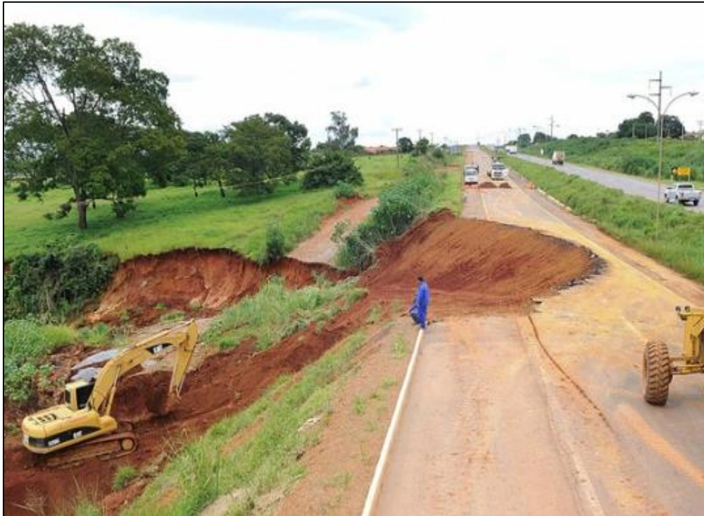
Figura 7 – Erosão na BR-153/GO em Anápolis
