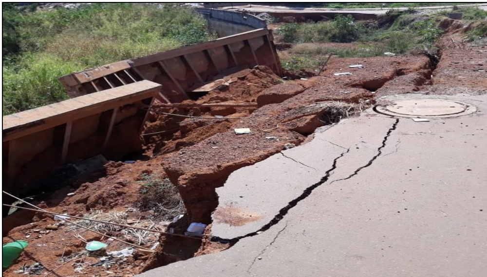
Figura 14 – Erosão invade o asfalto / Agosto de 2018
