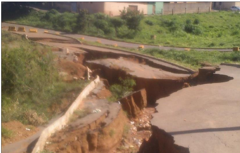
Figura 9 – Erosão invade o asfalto
