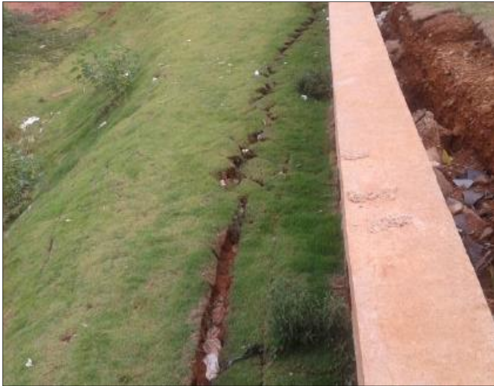
Figura 12 – Início do rompimento da contenção / Novembro
