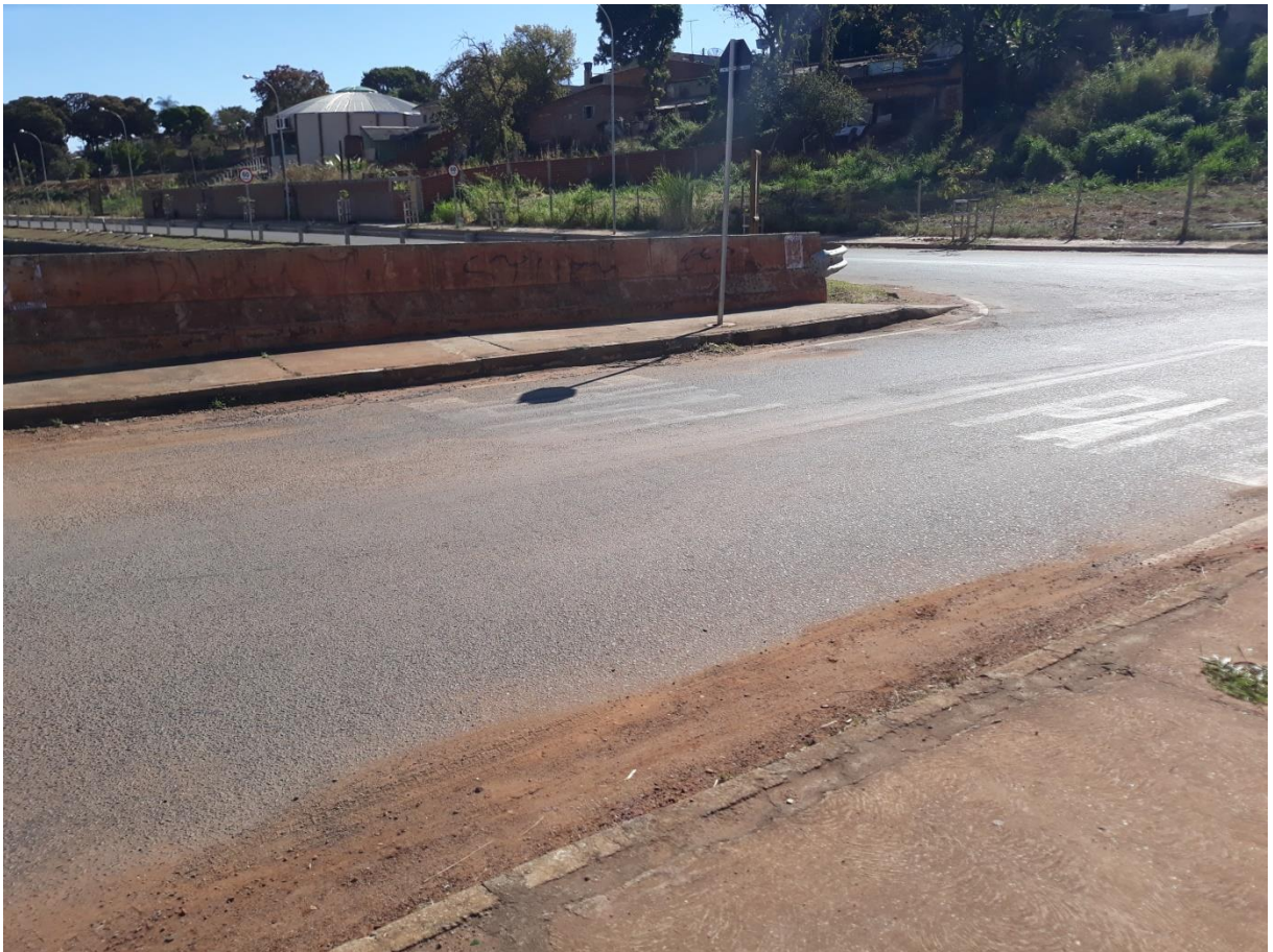
Figura 27 – Ausência de drenagem em OAE n° 31
