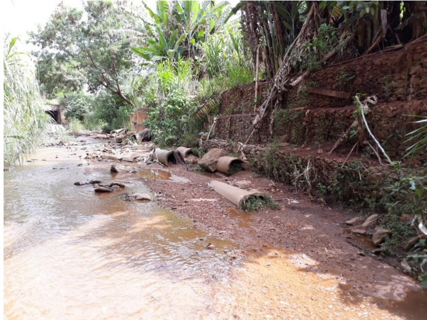
Figura 33 – Proteção em montante na OAE n° 54
