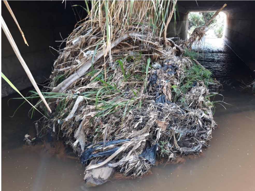
Figura 36 – Entupimento parcial na OAE nº 52
