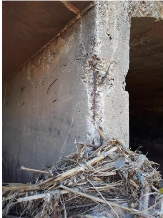
Figura 39 – Armadura exposta na OAE n° 20
