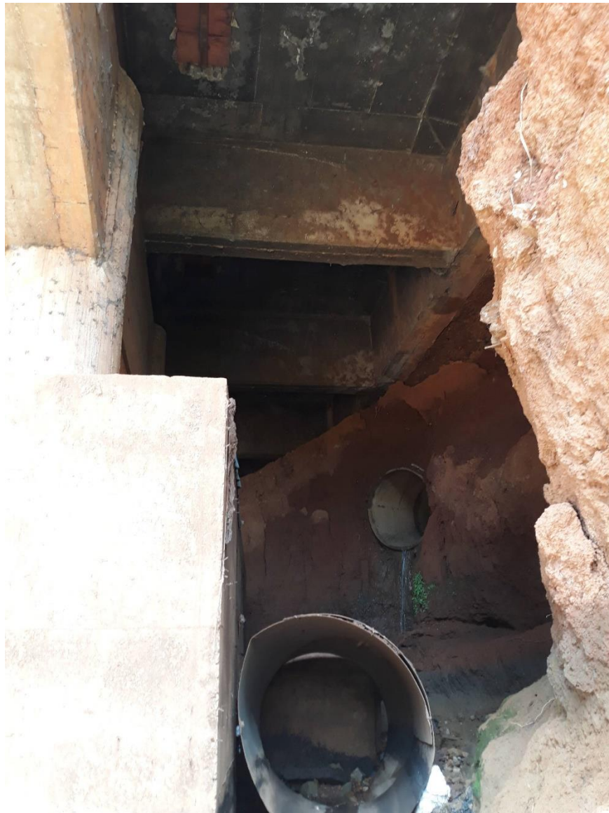
Figura 31 – Encontro com erosão retirada da OAE nº 51
