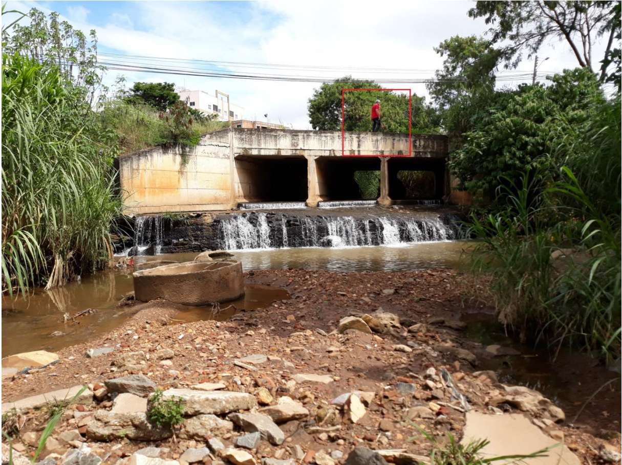
Figura 26 – Falta de guarda corpo na OAE nº 53
