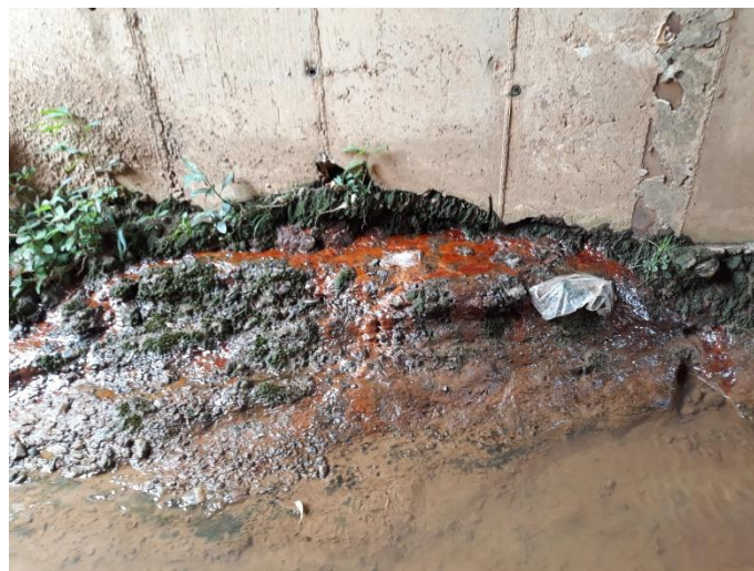
Figura 17 - Biodeteriorização em concreto
