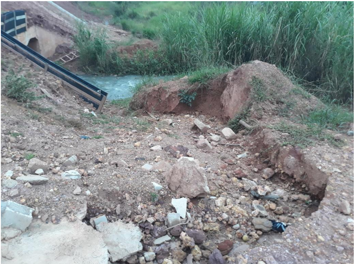
Figura 40 – Erosão na OAE nº 56
