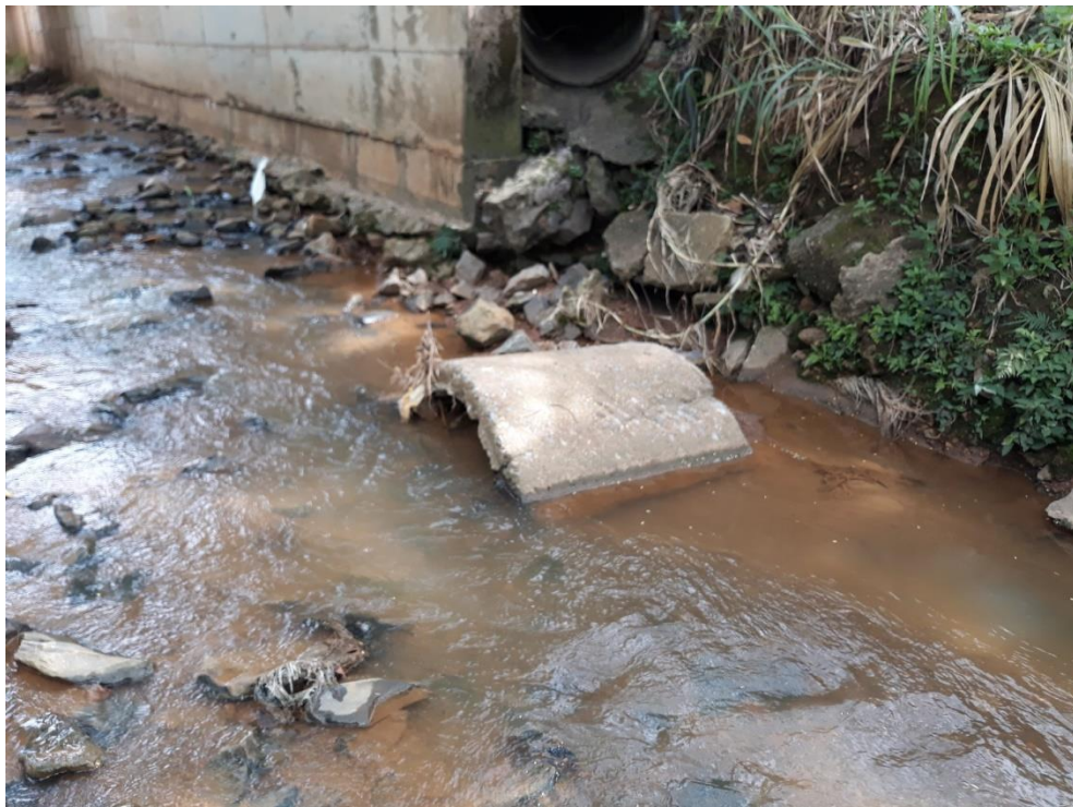
Figura 37 – Detritos de drenagem pluvial na OAE nº 55
