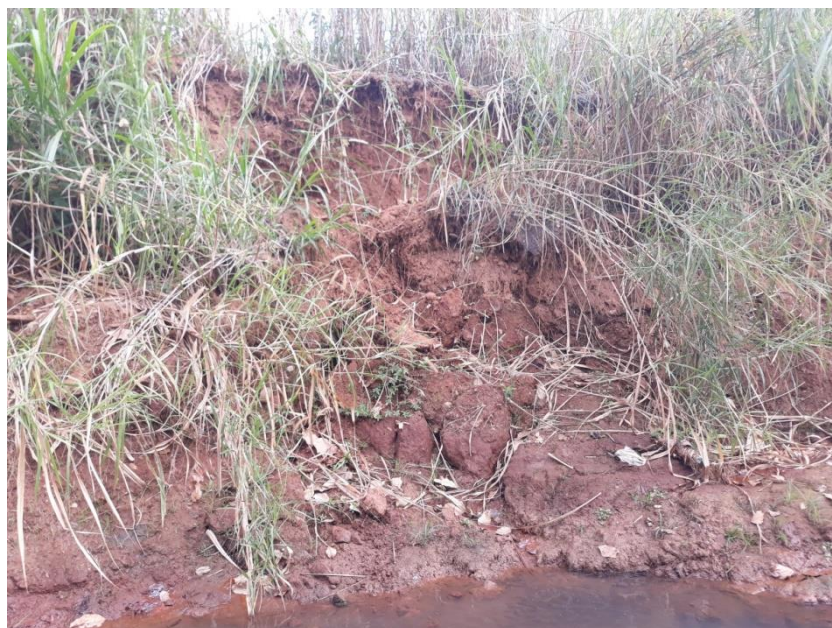
Figura 34 – Erosão em montante na OAE n° 20
