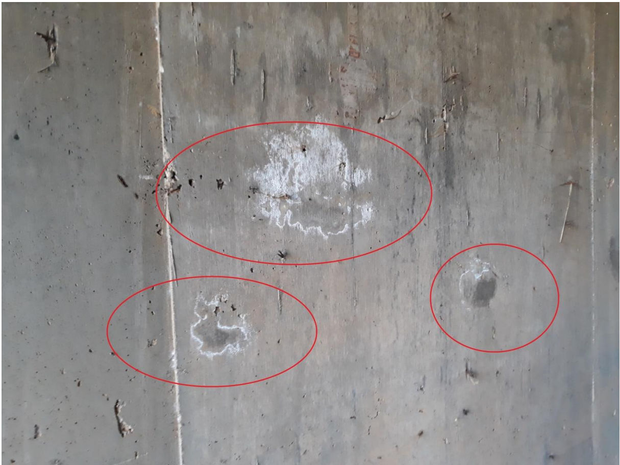
Figura 25 – Eflorescências como resultado de lixiviação na OAE nº 47
