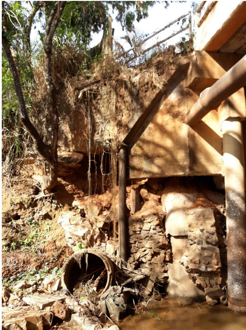
Figura 32 – Ala com erosão retirada da OAE nº 48
