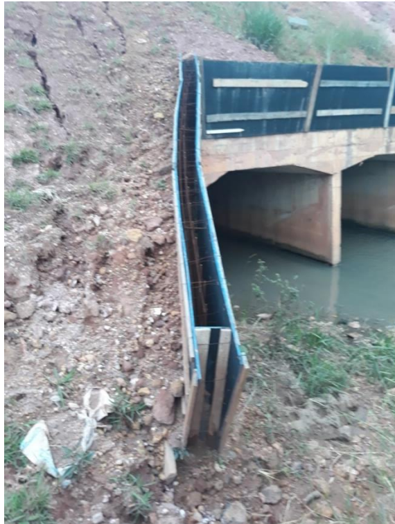
Figura 41 – Ala incompleta na OAE nº 56
