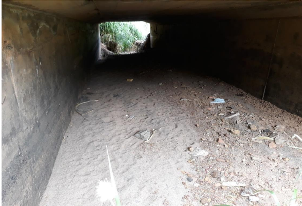
Figura 35 – Canal entupido na OAE n° 20
