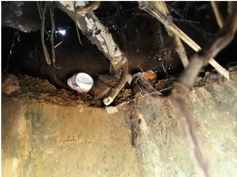
Figura 29 – Bueiro parcialmente entupido em OAE nº 52
