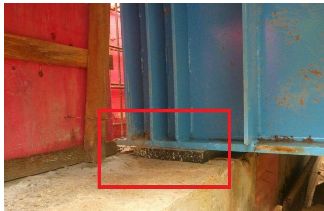
Figura 10 - Aparelhos de apoio em elastômero fretado
