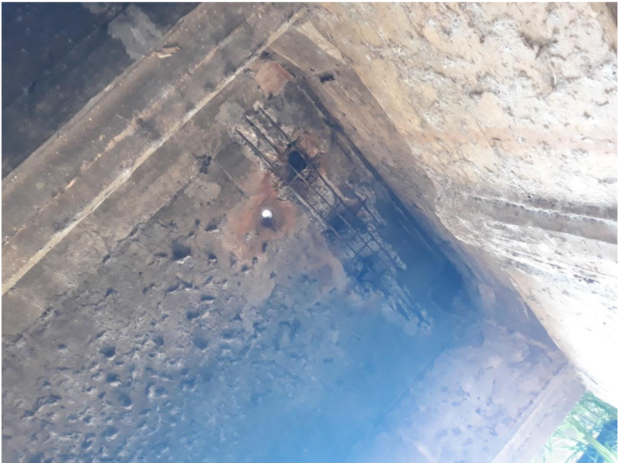
Figura 38 – Armadura exposta na OAE nº 8
