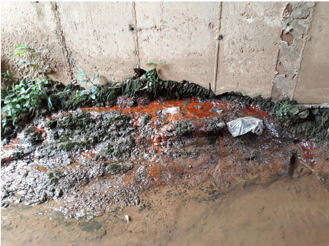
Figura 30 – Biodeteriorização em OAE n° 54
