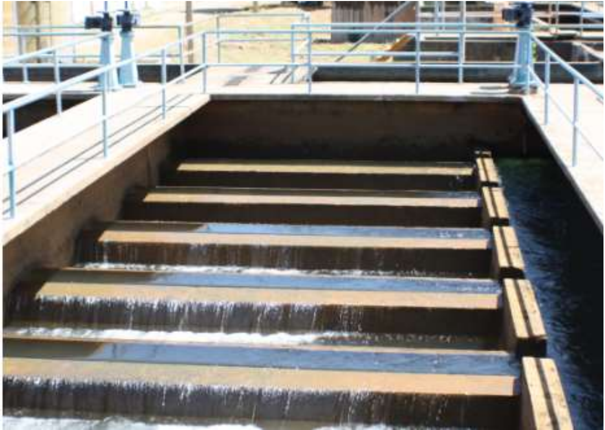
Figura 5 - Floculador para tratamento de efluentes
