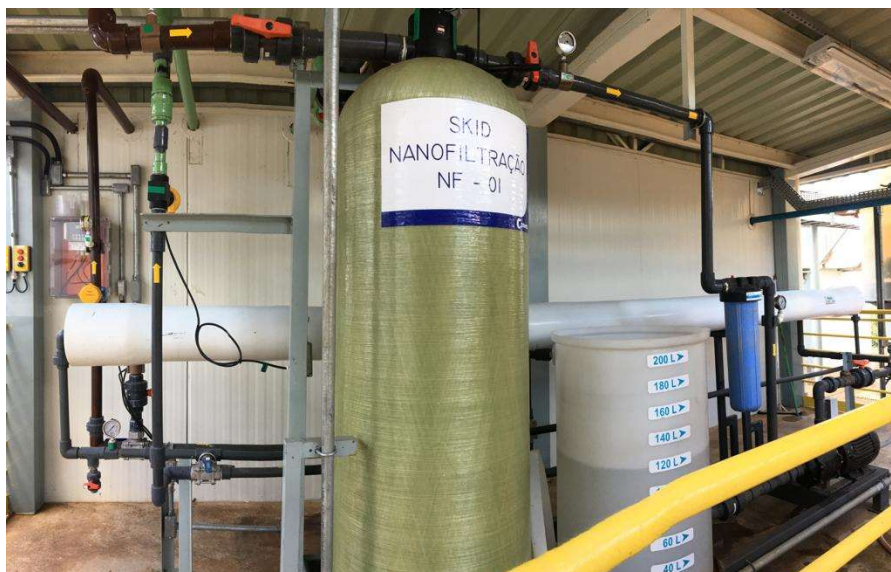
Figura 13 - Sistema de nanofiltração instalado
