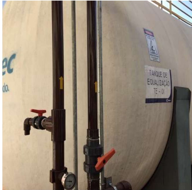
Figura 15 : Efluente bruto equalizado (Tanque de equalização)
