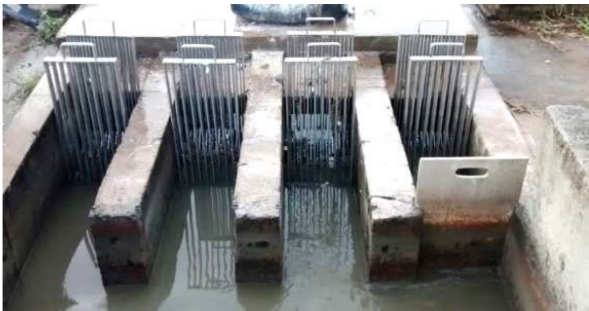
Figura 3 - Sistema de gradeamento de efluente
