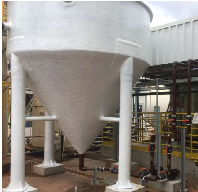
Figura 17 : Efluente após tratamento biológico (tanque secundário)
