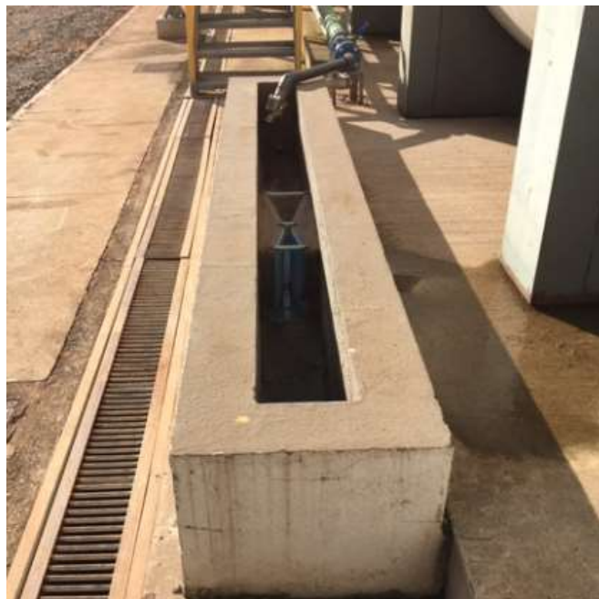
Figura 16 : Efluente tratado(calha Parshall)
