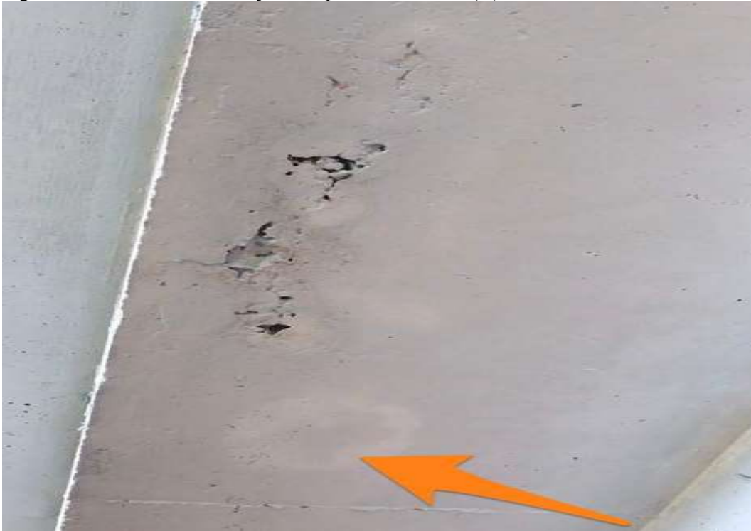
Figura 11 – eflorescência na laje da arquibancada, setor (A)
