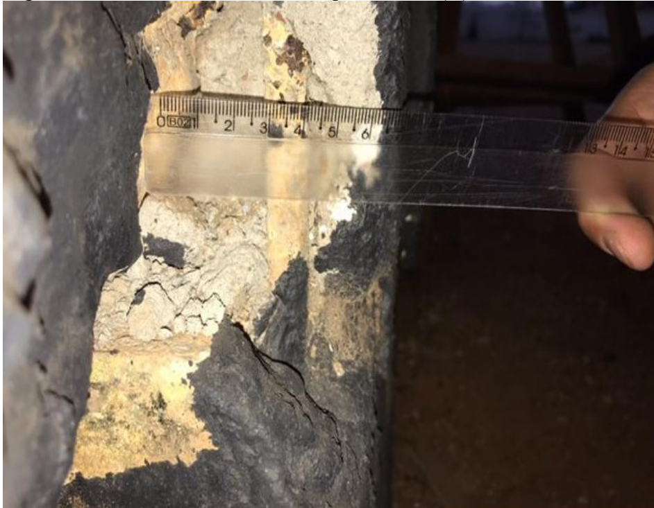
Figura 8 – Corrosão na armadura do pilar , setor (A)
