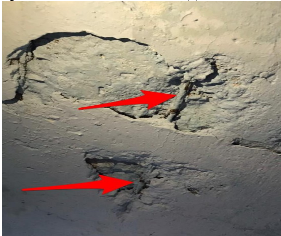
Figura 7 – corrosão na armadura do túnel, setor (C)
