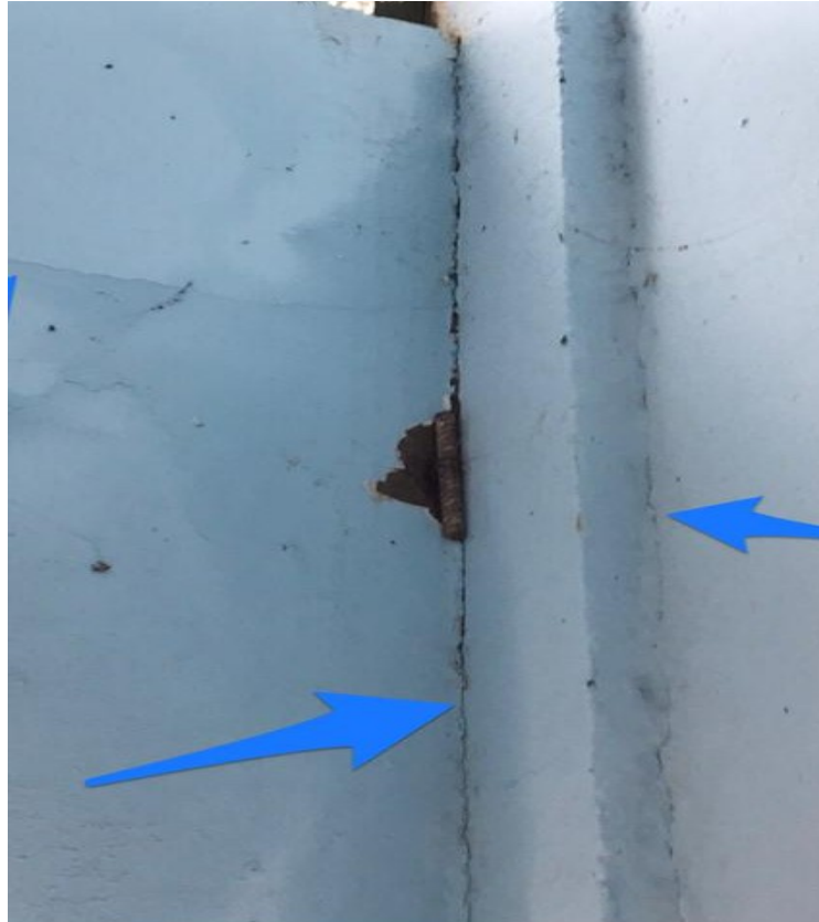
Figura 6 – Trinca no depósito, setor (A)
