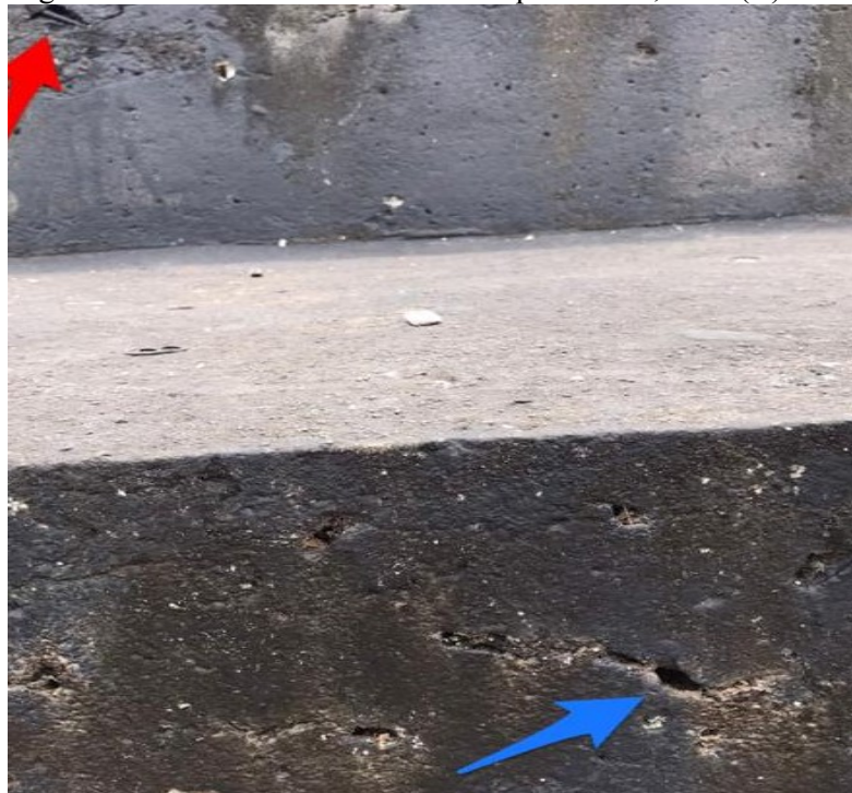
Figura 5 – Corrosão na armadura da arquibancada, setor (C)
