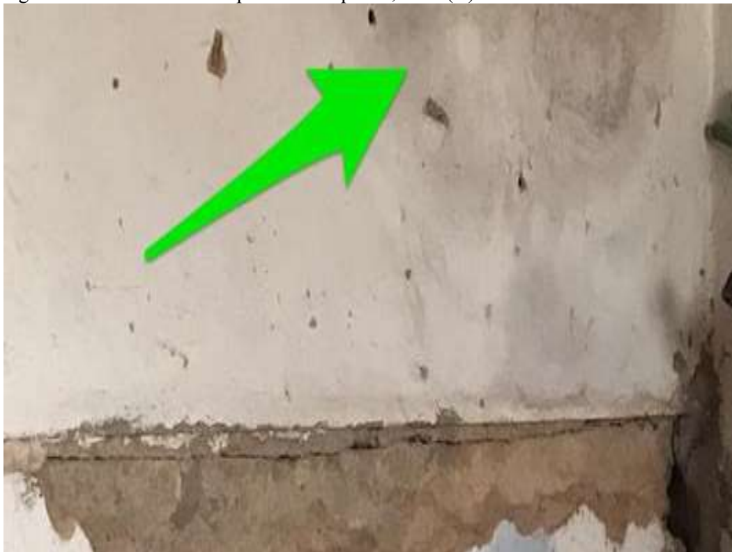
Figura 12 – Eflorescência na parede do depósito, setor (A)
