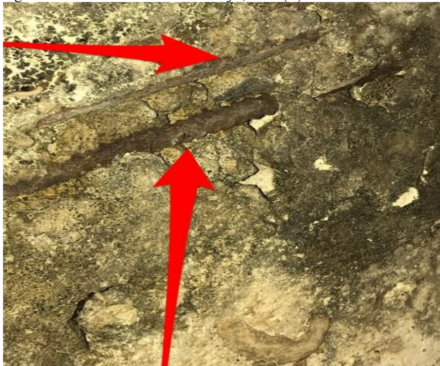
Figura 9 – corrosão na armadura da laje , setor (C)
