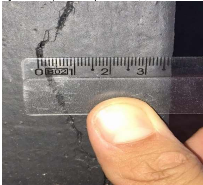
Figura 1 - Fissuração vertical no pilar 2 do setor (A)
