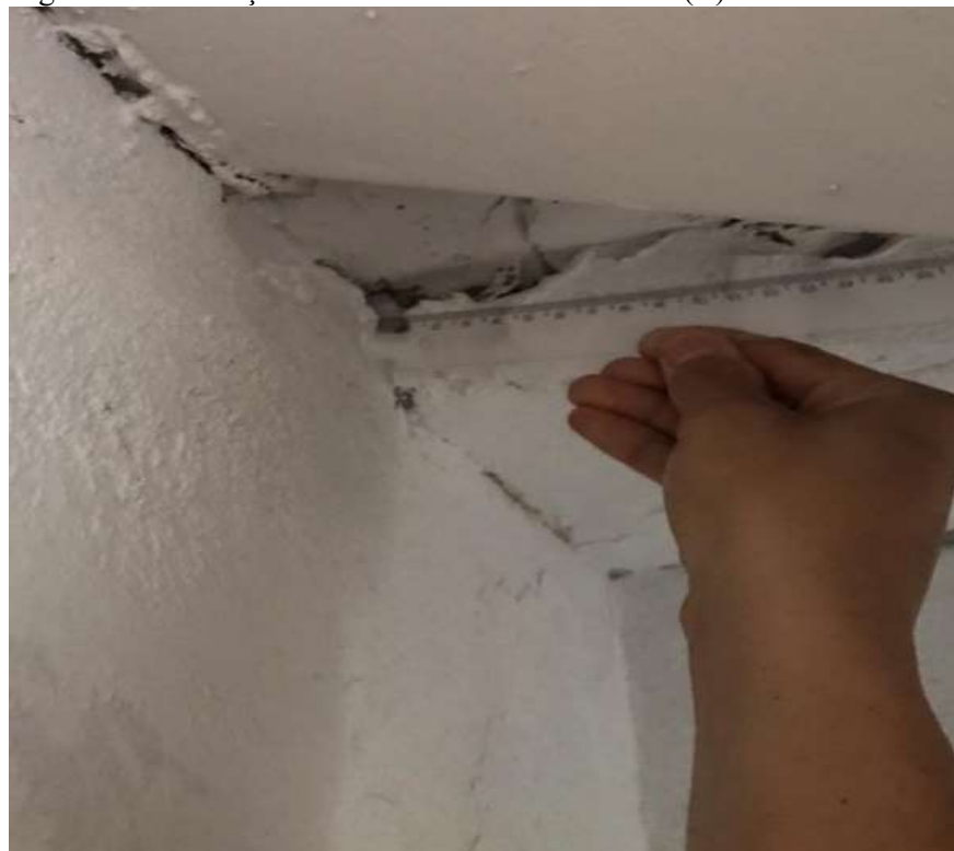
Figura 2 – Fissuração Horizontal na cabine do setor (B)
