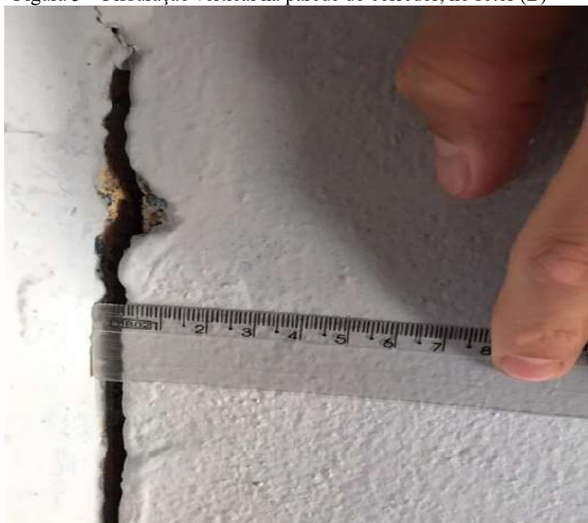
Figura 3 – Fissuração vertical na parede do corredor, no setor (B)
