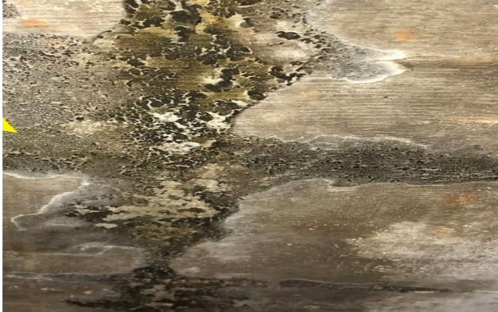
Figura 10 – ocorrência de eflorescência na laje do banheiro, setor (B)
