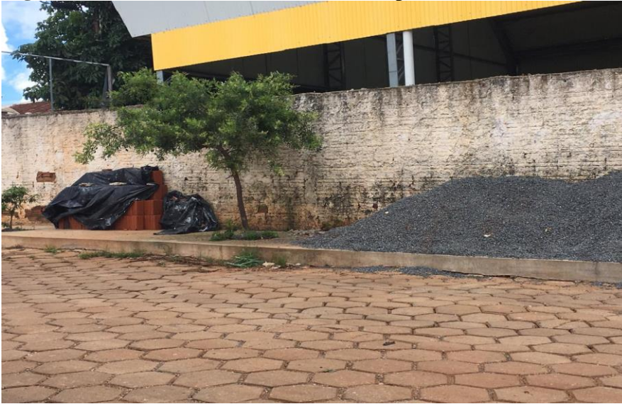
Figura 3. Armazenamento de materiais no passeio e na rua.
