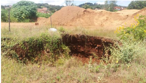
Imagem 02 – Caixa de contenção que se rompeu devido o material que é feita e a demanda de água que evidentemente foi maior que o suportado. Está localizada em um depósito de areia bem próximo de um Posto de Saúde da cidade de Ceres. Fonte: MOURA, 20 de março de 2017.
