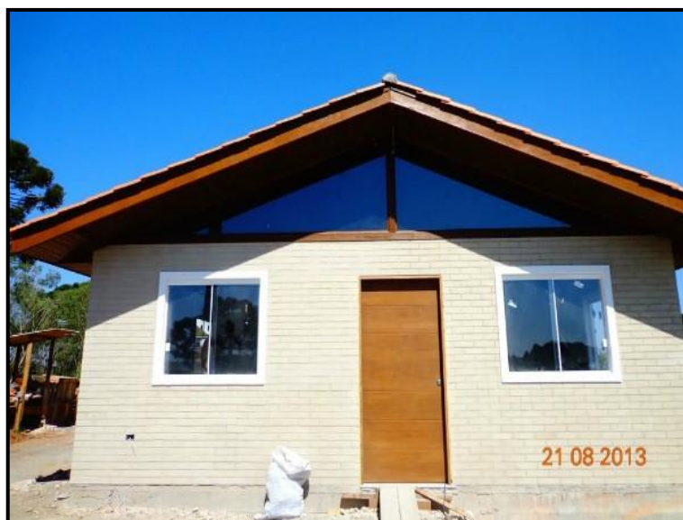
Figura 23 - Residência com pintura direta na alvenaria
