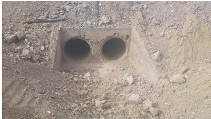
Figura 4.13 -Bueiro tubular (Autoria Própria)
