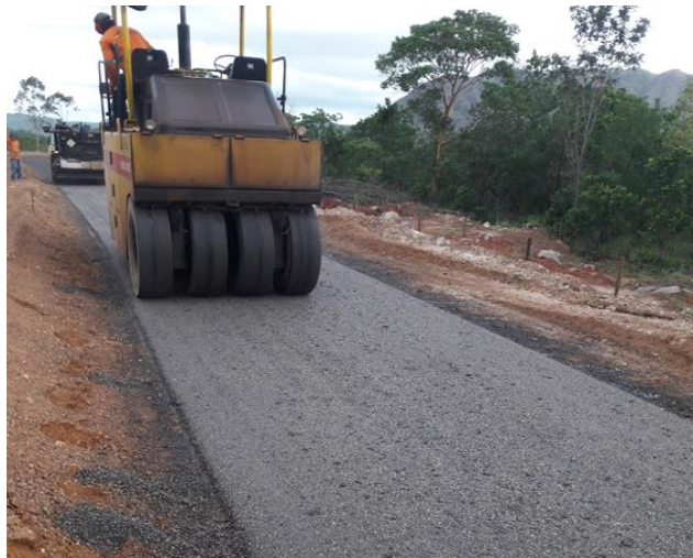
Figura 4.27 - Rolo compactador pneumático (Autoria Própria)
