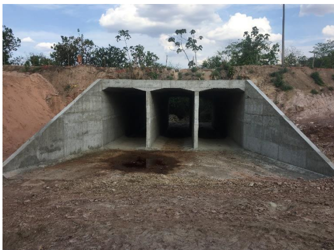
Figura 4.15 - Bueiro celular (Autoria Própria)
