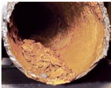
Figura 1 - Corrosão Interna Generalizada
