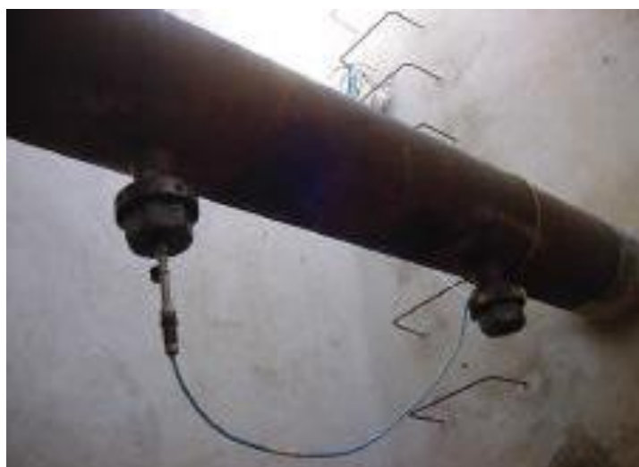
Figura 6: Caixa de inspeção com sistemas de monitoramento instalado em campo
