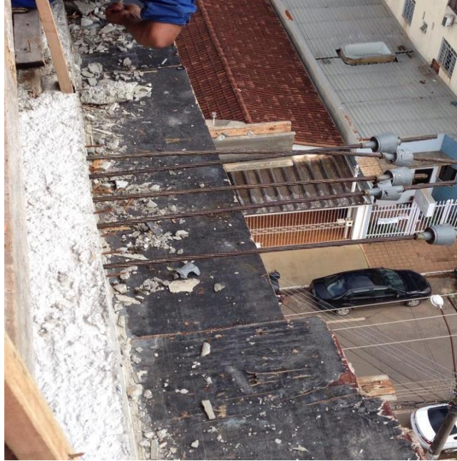
Figura 32 – Copinhos retirados e cabos fora da estrutura
