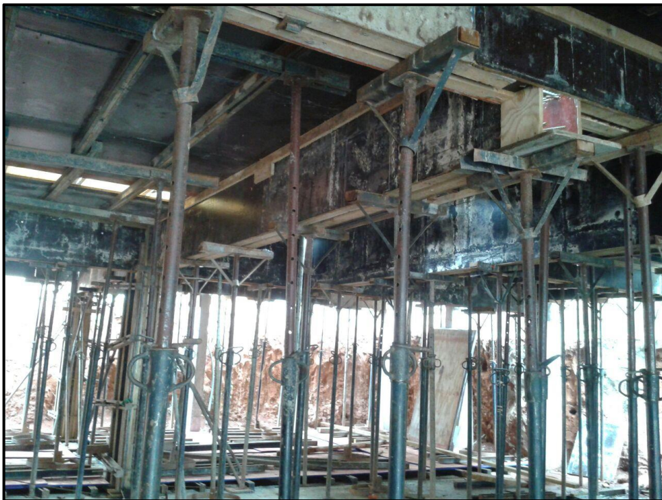
Figura 19 – Uso de escoramento metálico em uma obra na cidade de Anápolis (GO)
