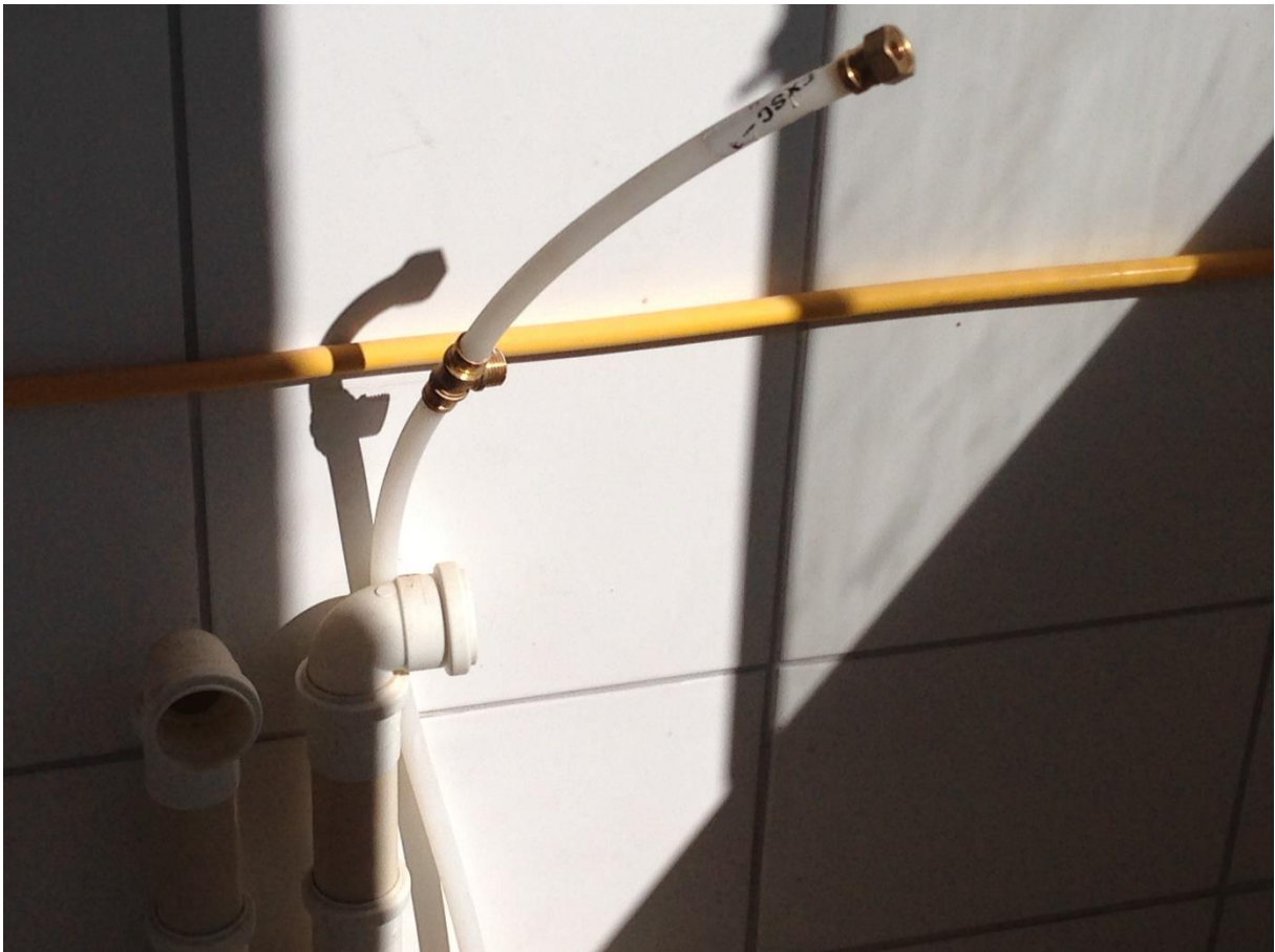
Figura 20 – Sistema Pex (água) e tubulação de gás
