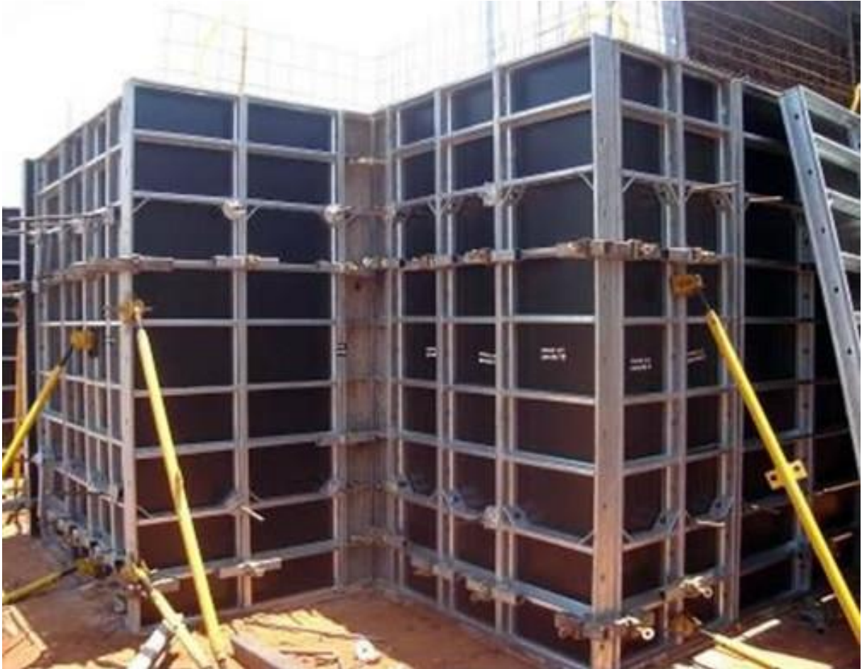
Figura 3 – Execução de fôrma com painéis em madeira e quadros em peças metálicas
