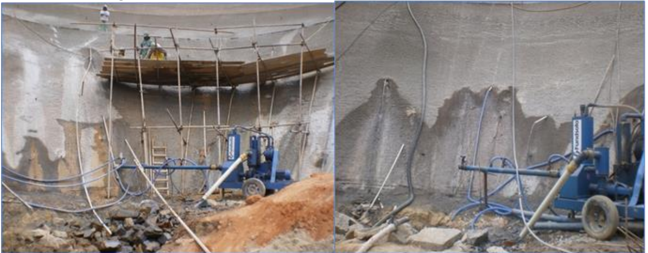
Figura 26 - DHP's (Drenos Horizontais Profundos) em funcionamento
