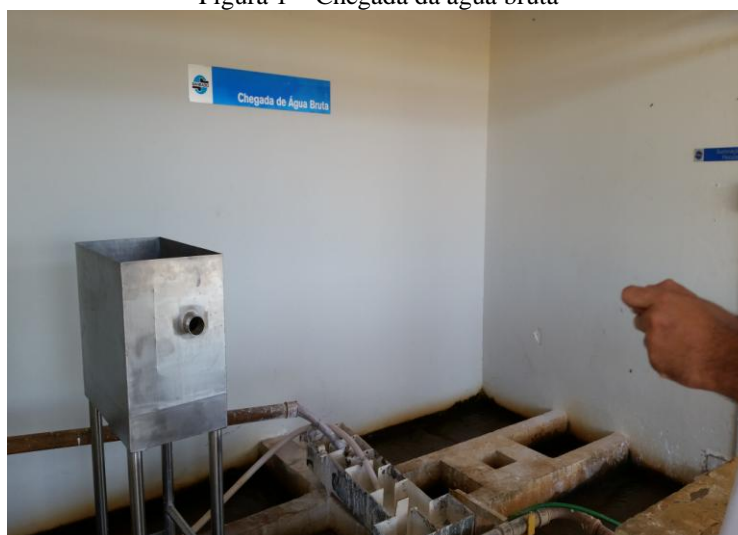
Figura 1 – Chegada da água bruta
