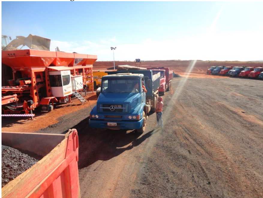
Figura 2 - Usina dosadora de solo-cimento
