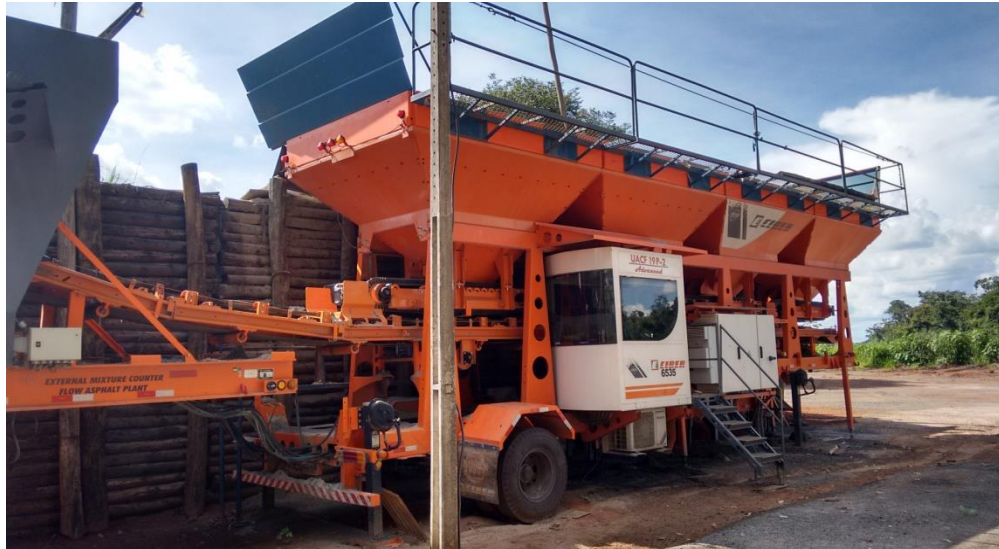
Figura 9 - Silos de armazenamento de agregados e torre de controle.
