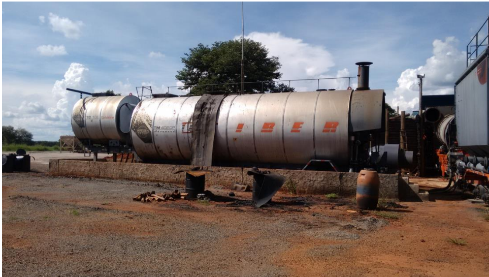
Figura 8 - Depósito para ligante asfáltico (reservatório de CAP)
