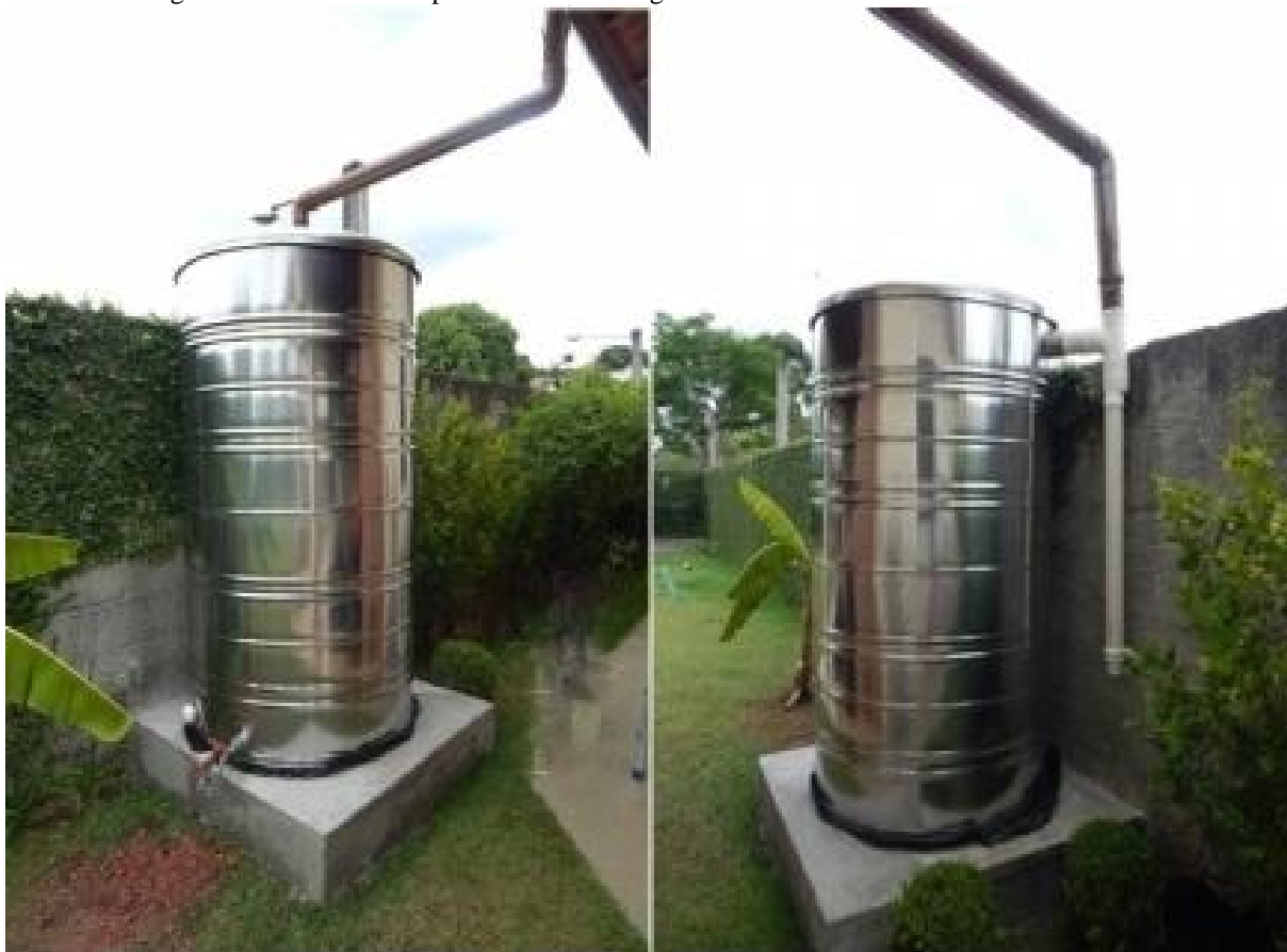
Figura 16 - Sistema de Aproveitamento de águas de chuva com reservatório sobre o solo
