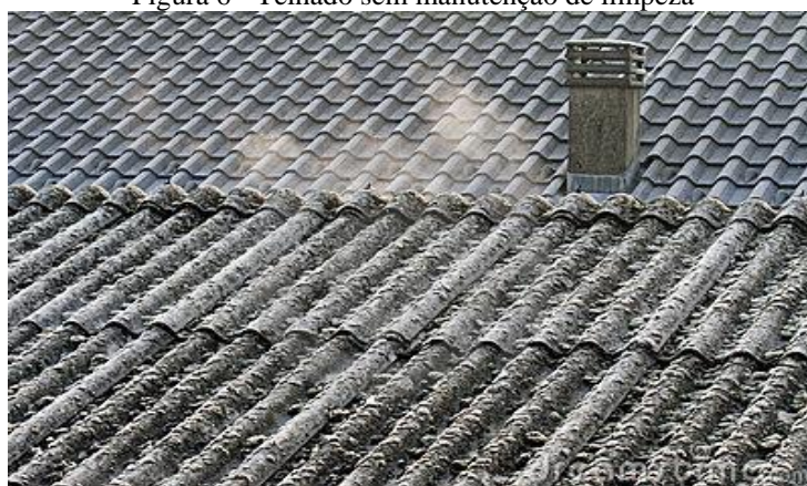
Figura 6 - Telhado sem manutenção de limpeza
