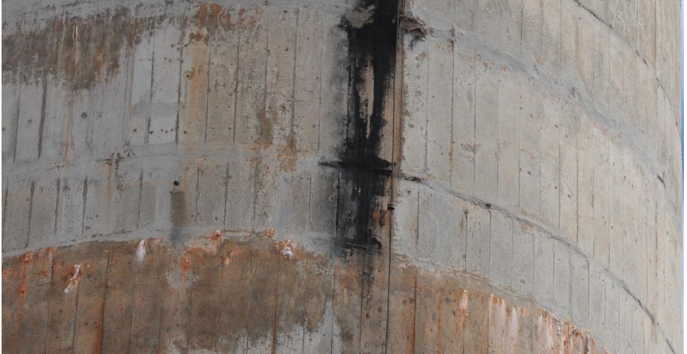
Figura 36 - Parede com manchas de cor escura e branca no ETA I - Jaiara
