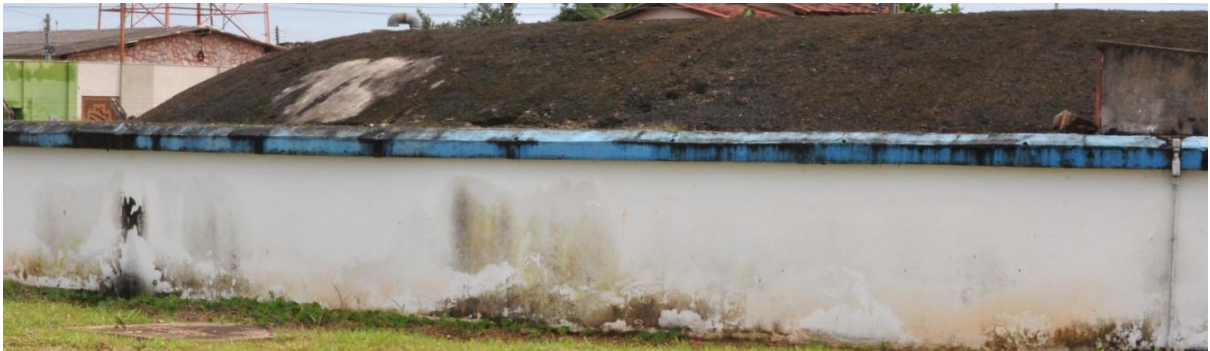
Figura 22 - Infiltração na parede externa do ETA I - SANEAGO Anápolis
