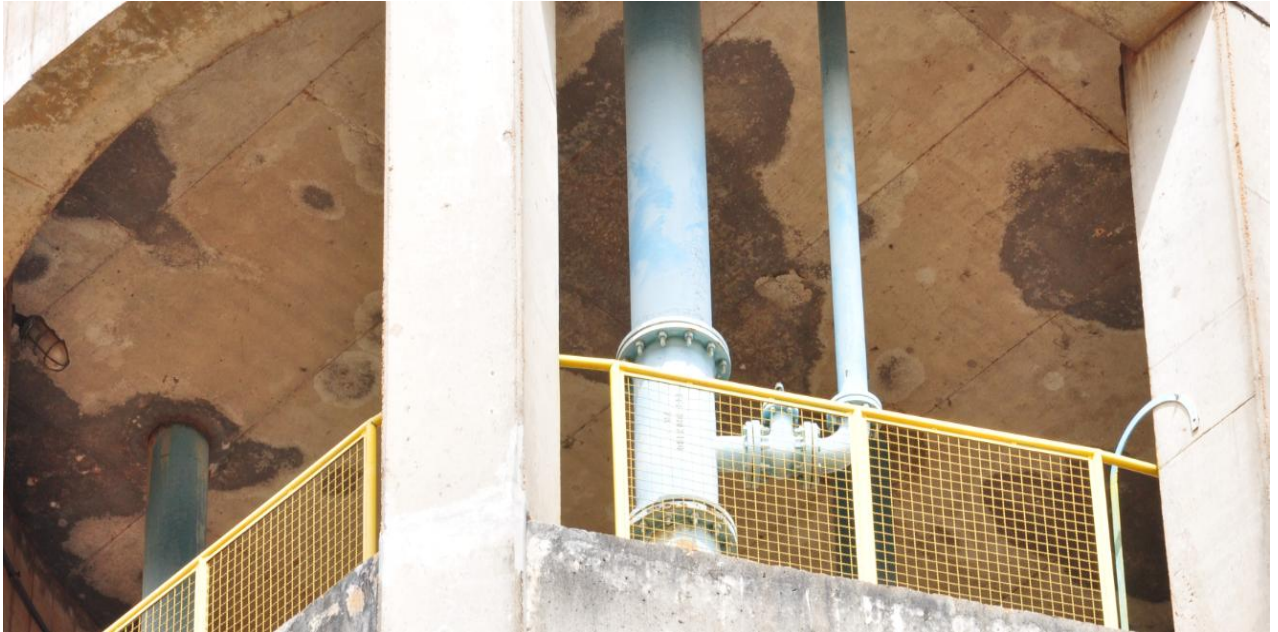
Figura 34 - Fundo da cuba do ETA I - Jaiara, com indícios de infiltração e carbonatação do concreto
