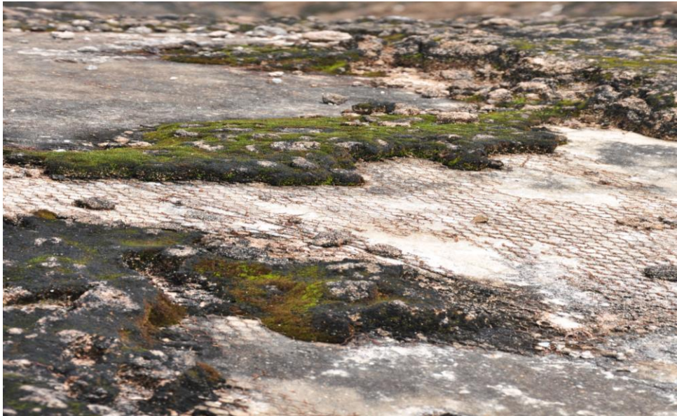
Figura 26 - Concreto desagregado e malha de aço exposta do reservatório ETA II
