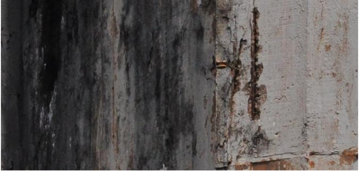
Figura 42 -Deslocamento do concreto pela corrosão da armadura no reservatório desativado da SANEAGO
