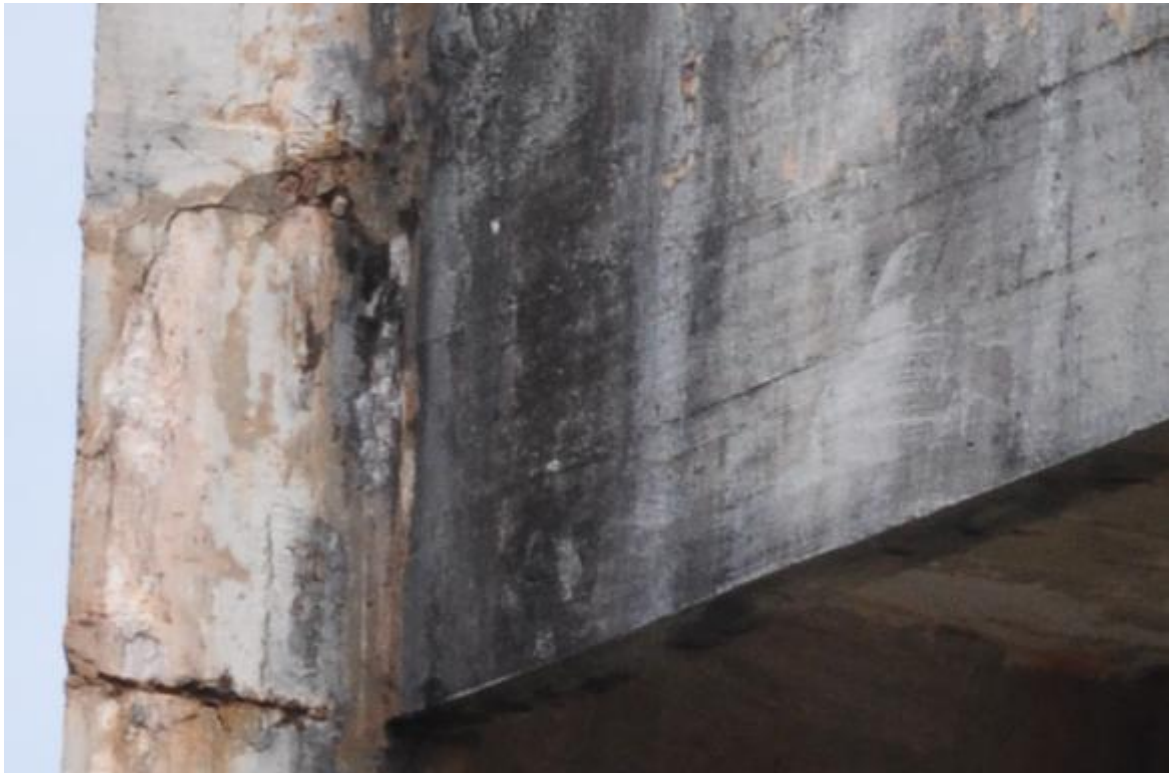
Figura 43 - Trinca no pilar do reservatório desativado
