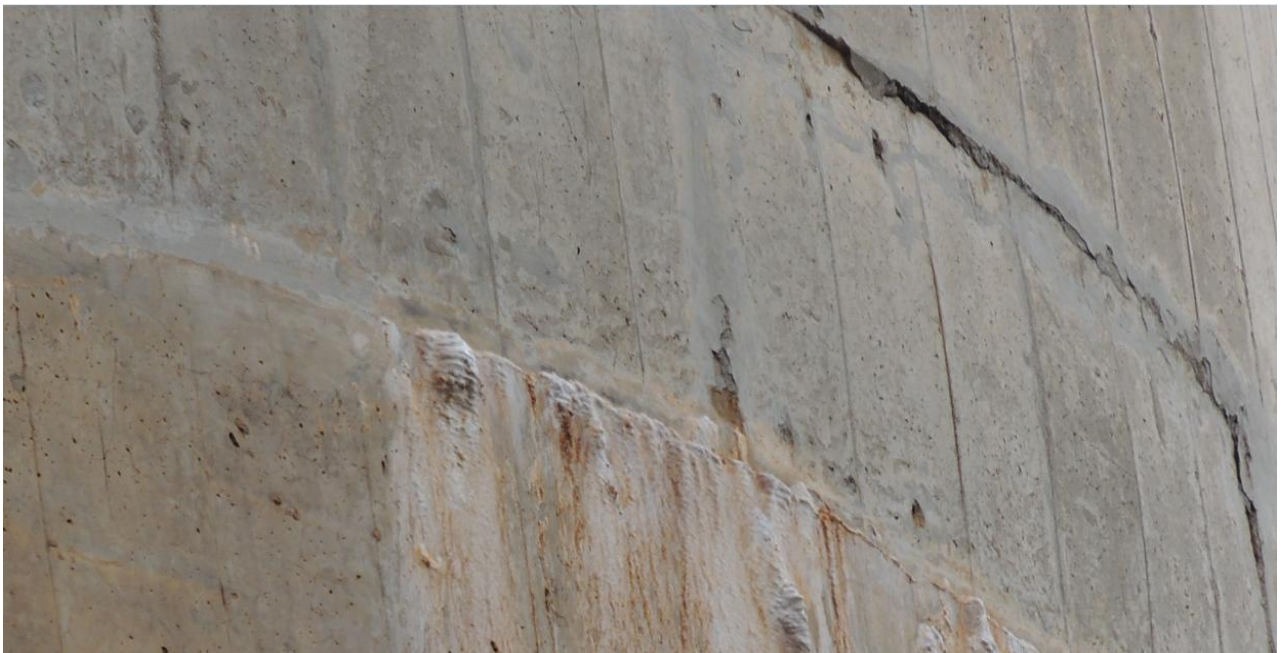
Figura 35 - Fissuras nas juntas de concretagem e formação de estalactites no ETA I - Jaiara
