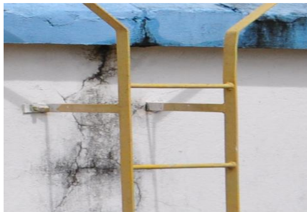
Figura 23 - Fissura na parede externa do ETA I - SANEAGO Anápolis
