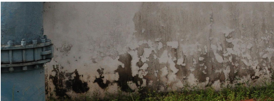
Figura 27 - Micro - fissuras e infiltração ETA II
