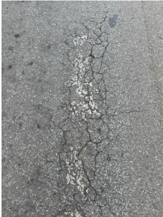
Figura 11 – Trinca couro de jacaré.
