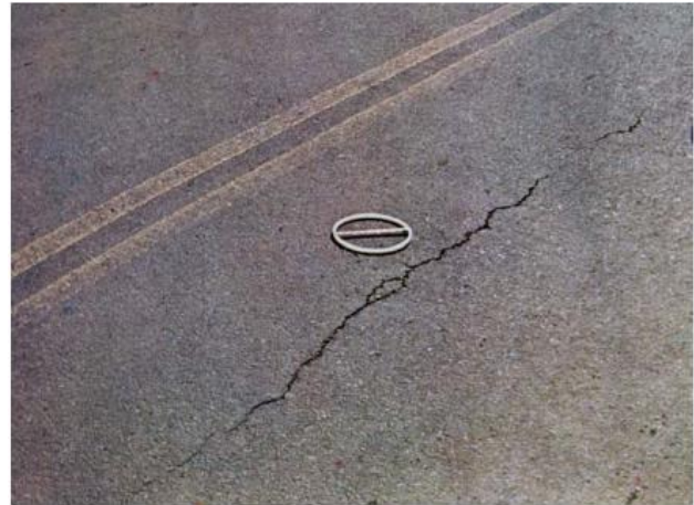
Figura 3 – Trinca isolada longitudinal
