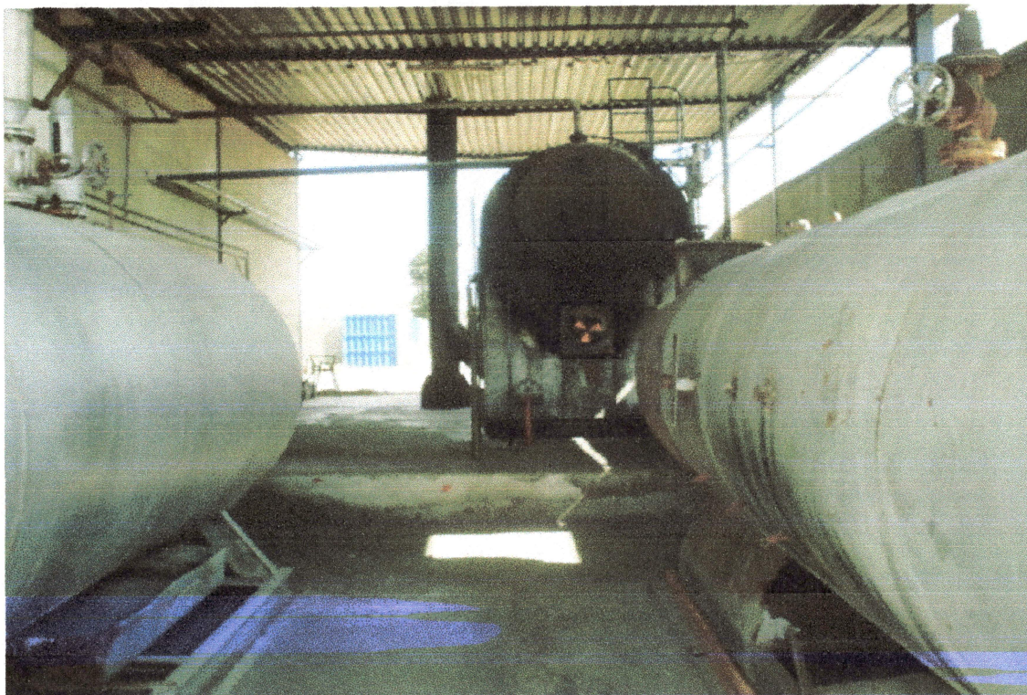
Figura 6 - Foto da sala das Caldeiras.
