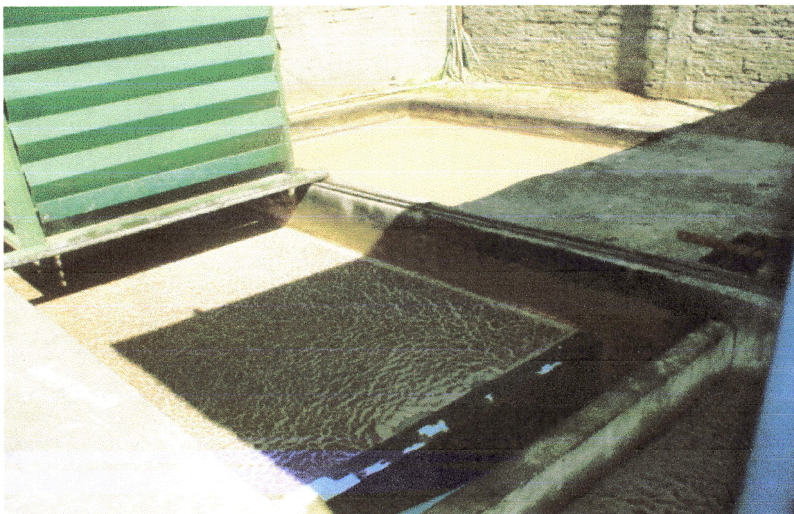
Figura 7 - Foto do Tratamento de Efluentes - Tanque de decantação.
