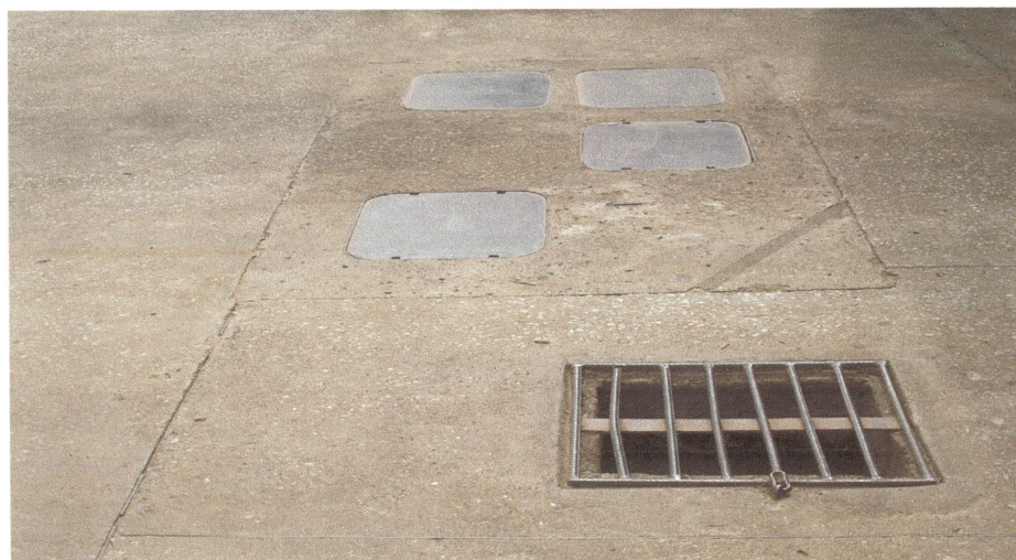
Figura 5: Caixa separadora de água e óleo
