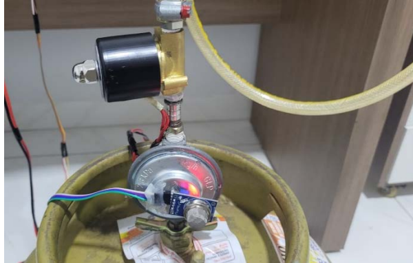
Figura 12 – Válvula solenoide instalada após o regulador de pressão e sensor de gás MQ-6 montado no regulador.
