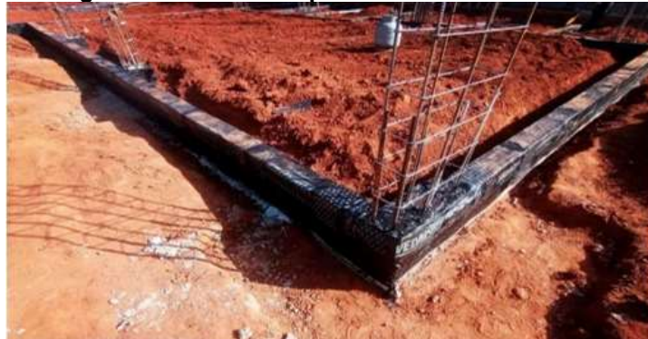
Figura 8 – Detalhe do pilar sem manta asfáltica.
