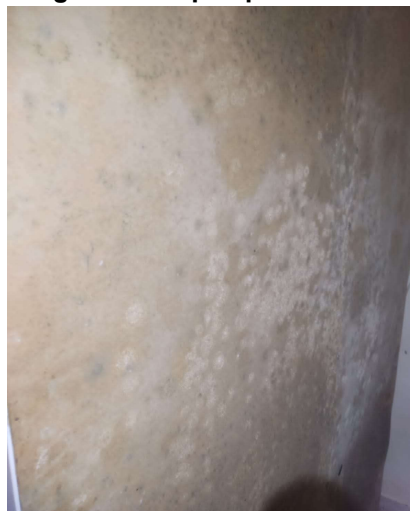
Figura 4 – Mofo presente no guarda roupas próximo a uma parede com infiltração.
