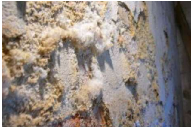
Figura 3 – Criptoflorescência na parede
