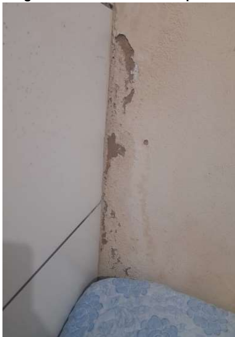
Figura 2 – Eflorescência na parede
