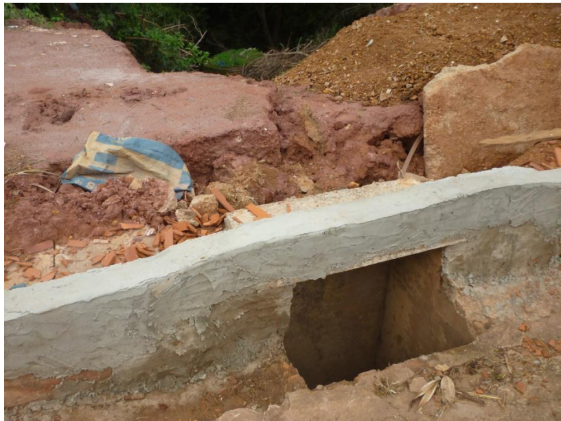
Figura 03 – Processos erosivos e declividade observadas na região da microbacia do córrego João Cesário em Agosto de 2014.
