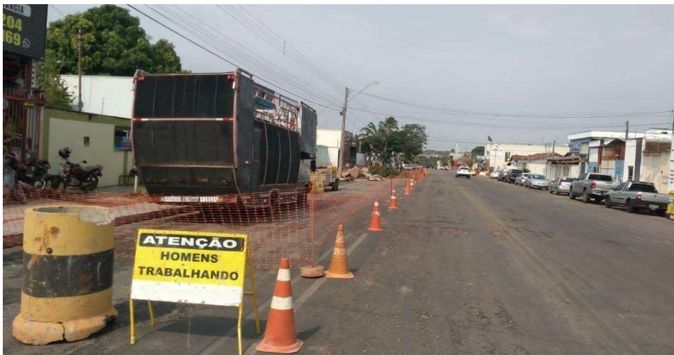
Figura 15 - Placa de sinalização e dispositivos de isolamento de área de risco.
