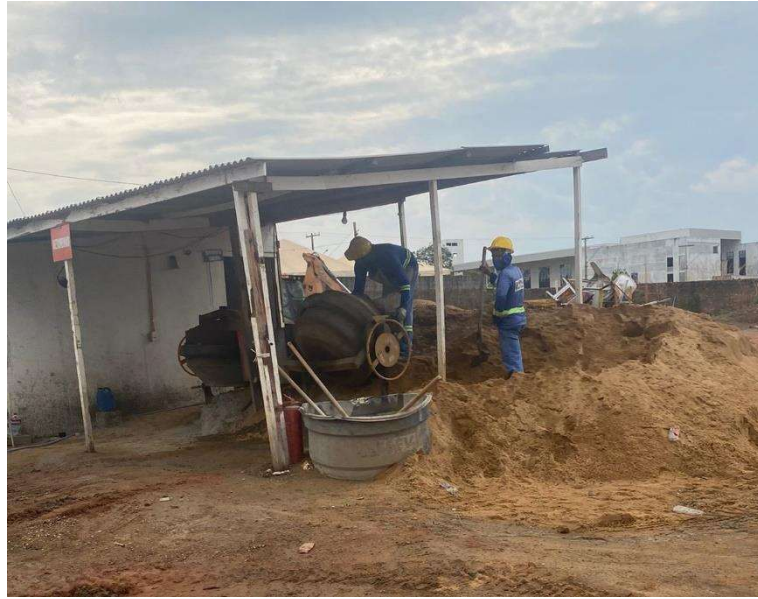
Figura 9 - Casa de betoneira.
