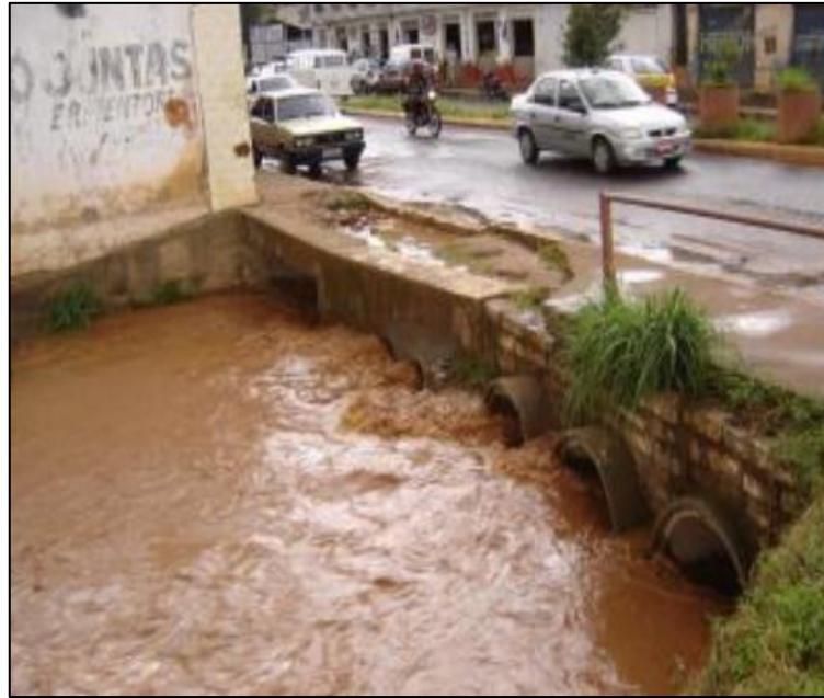
Figura 14 – Anilhas de concreto
