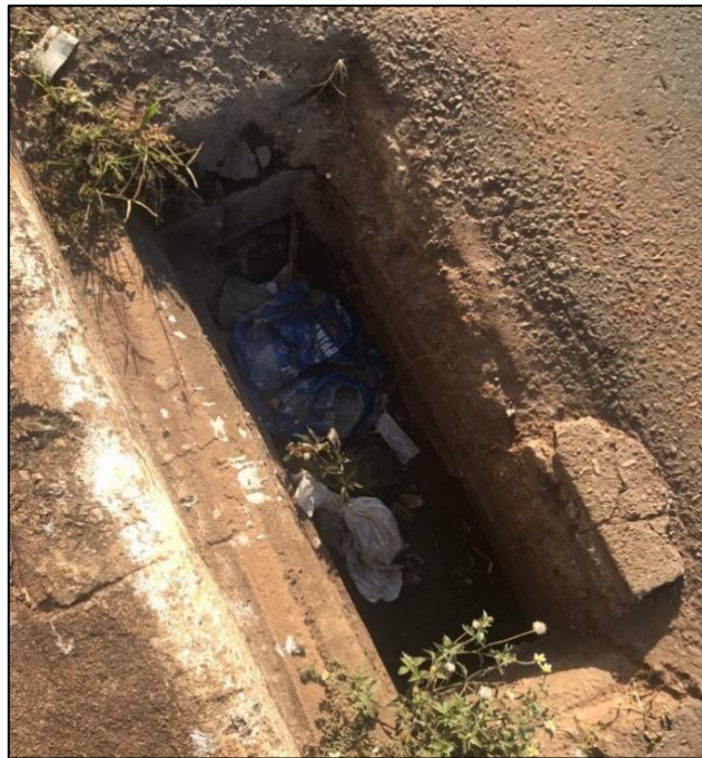
Figura 11 – Boca de lobo 1
