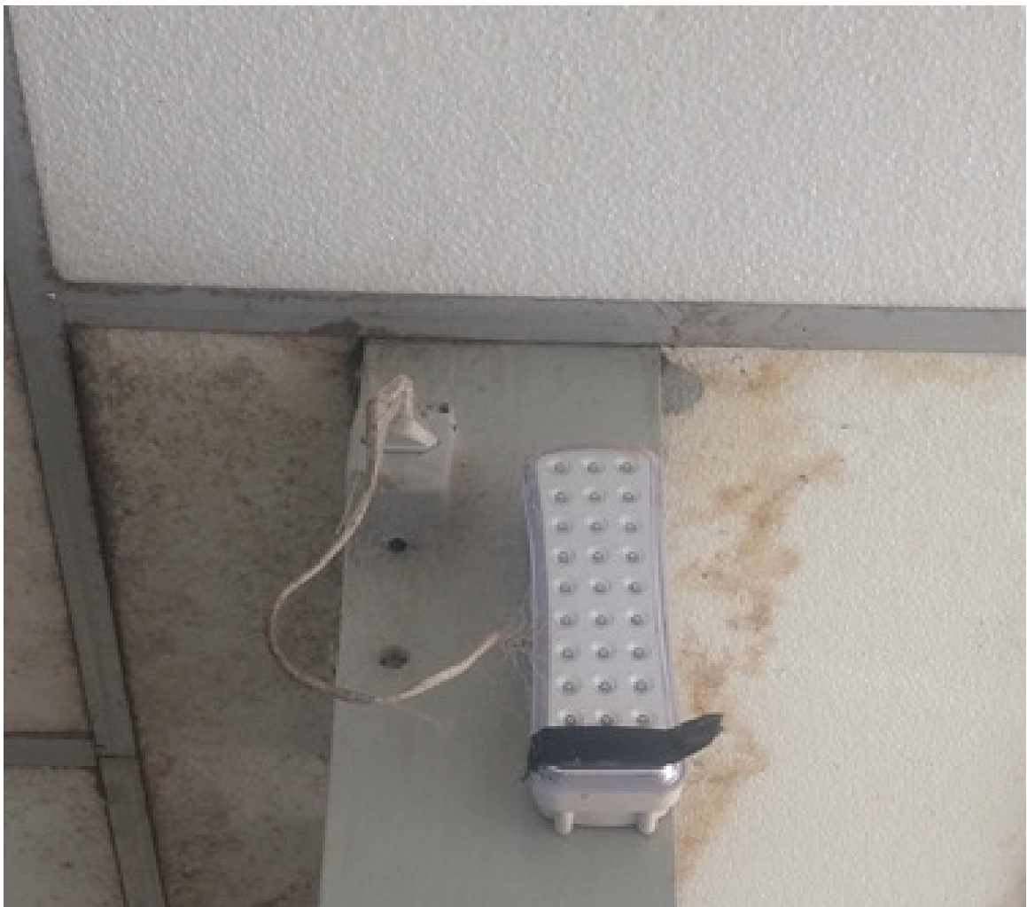
FIGURA 9: LUMINÁRIA DE EMERGÊNCIA SECRETARIA DE OBRAS DE ANÁPOLIS
