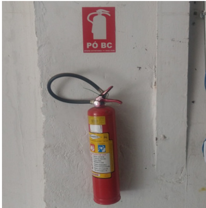
FIGURA 10: EXTINTORES DE INCÊNDIO SECRETARIA DE OBRAS DE ANÁPOLIS
