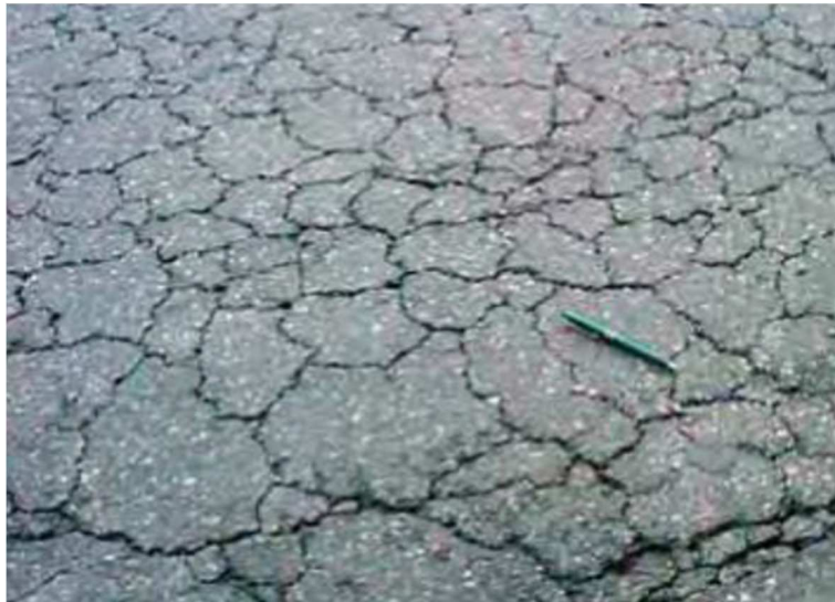
Figura 12 – Trinca por fadiga – tipo jacaré
