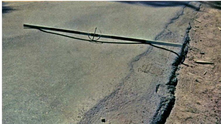
Figura 7 – Afundamento por trilha de rodas
