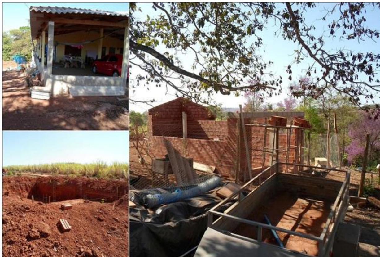
Figura 25. Construção em Área de Preservação Permanente às margens do rio das Almas no município de Nova Glória-GO.
