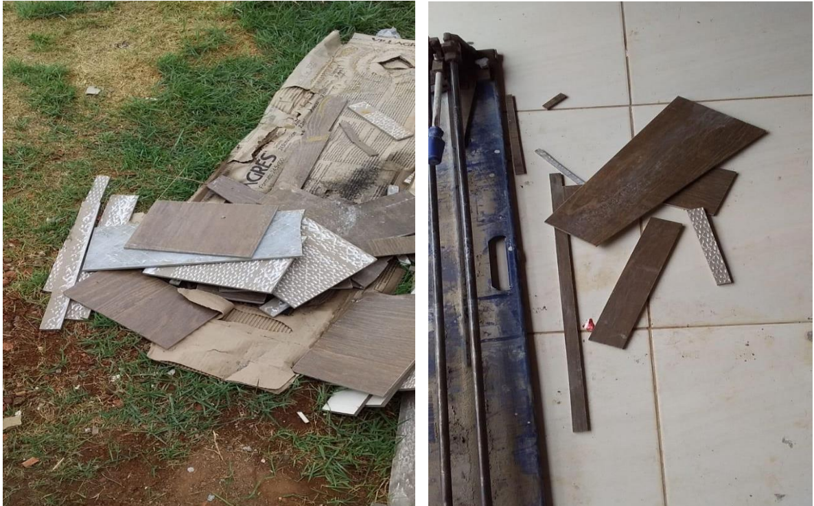
Figura 12 – Restos de revestimento
