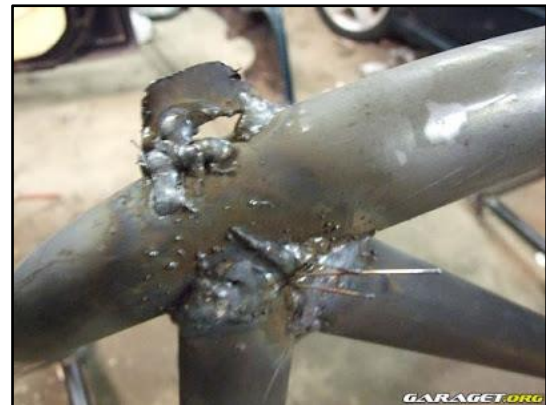
Figura 6 – Defeitos de solda em estrutura metálica 4
