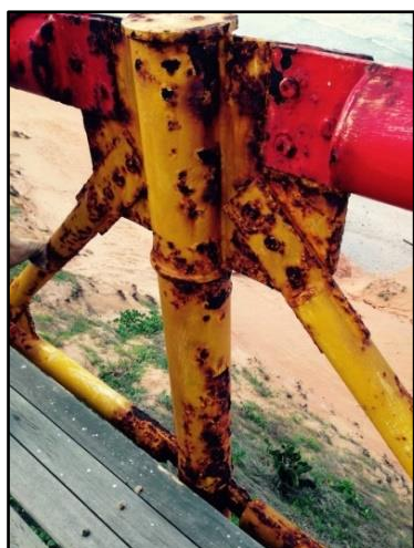
Figura 11 - Corrosão por Pontos 11
