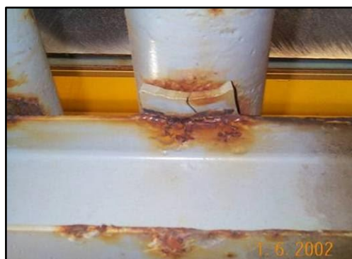
Figura 12 – Corrosão por Frestas 12
