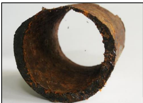
Figura 9 – Corrosão por Erosão 9
