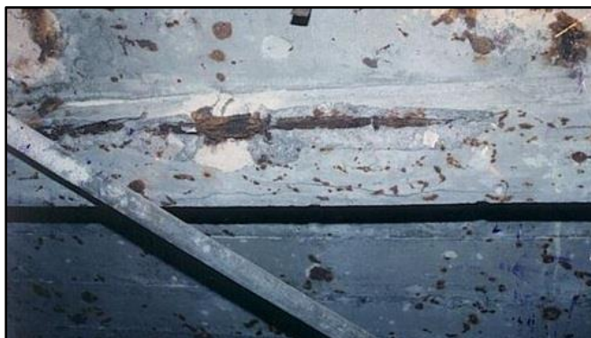
Figura 8 – Corrosão por Lixiviação 8
