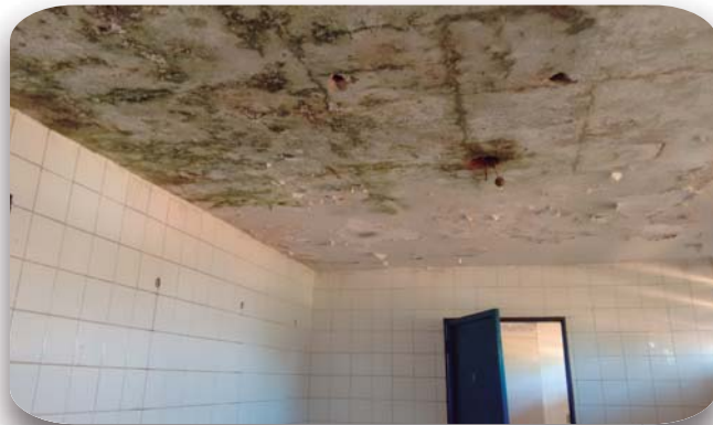
Foto 3 – Infiltração na laje decorrente das telhas avariadas
