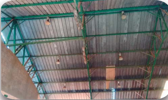
Foto 6 – Estrutura oxidada no telhado
