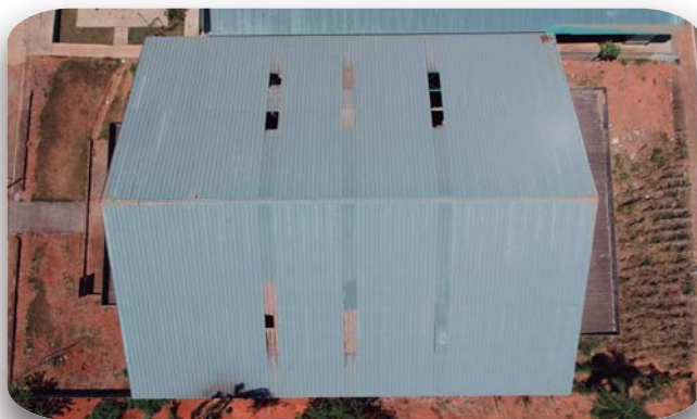
Foto 2 – Telhas avariadas na laje da cobertura do ginásio
