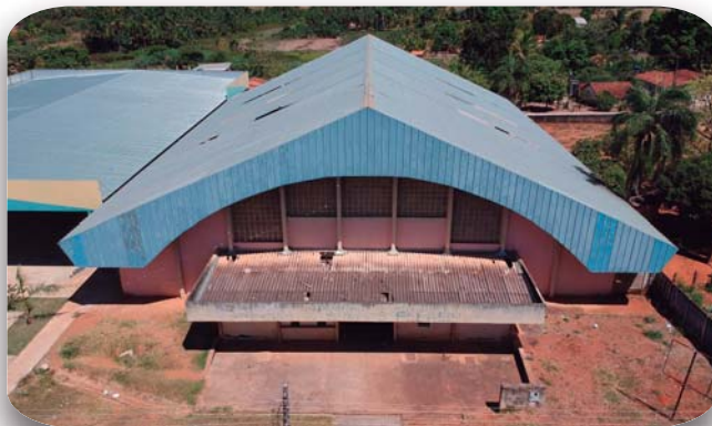
Foto 1 – Telhas avariadas na laje da cobertura da bilheteria
