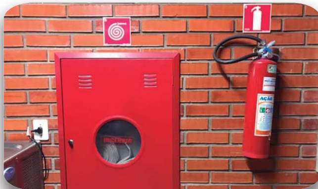
Foto 10 – Utilização de extintores
