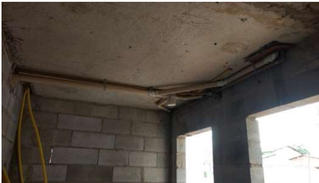
Figura 42: Tubulação sanitária e hidráulica da cozinha e da lavanderia, abaixo da laje
