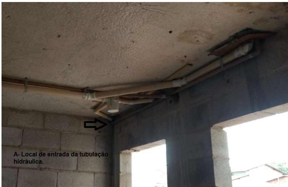
Figura 44: Local de entrada da tubulação hidráulica no apartamento
