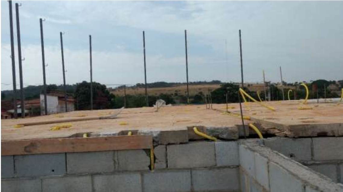
Figura 35: Após ser conectado os eletrodutos, as lajes recebem grauteamento em suas extremidades e entre as lajes.
