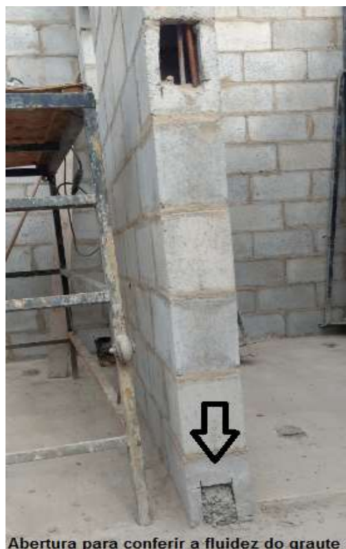
Figura 18: Ponto de graute com abertura em sua base
