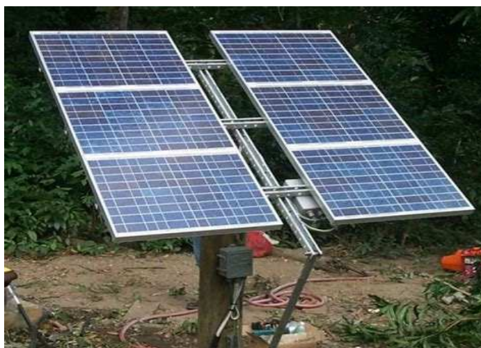
Figura 1: Painel Fotovoltaico com potência de 365 w
