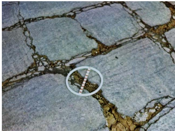
Figura 25 - Trincas em blocos
