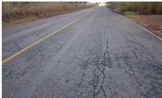
Figura 23 - Trincas por reflexão
