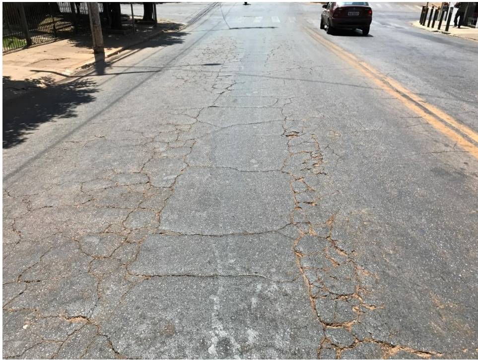
Figura 40 - Trinca em blocos
