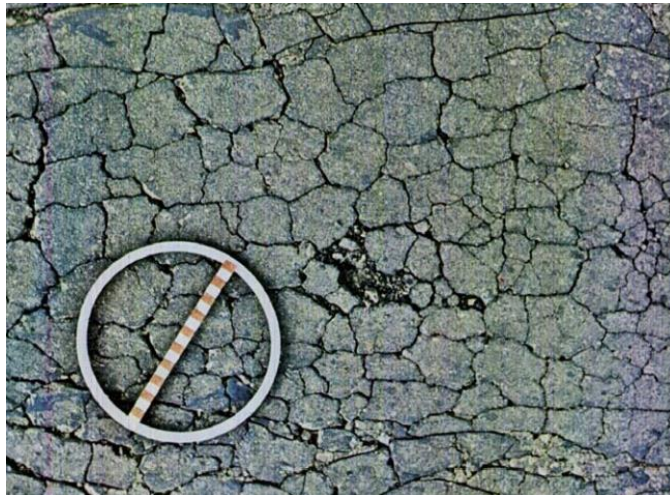
Figura 26 - Trinca por fadiga tipo "couro de jacaré"
