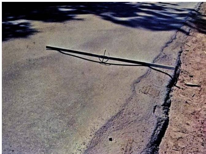
Figura 15 - Afundamento da trilha de roda
