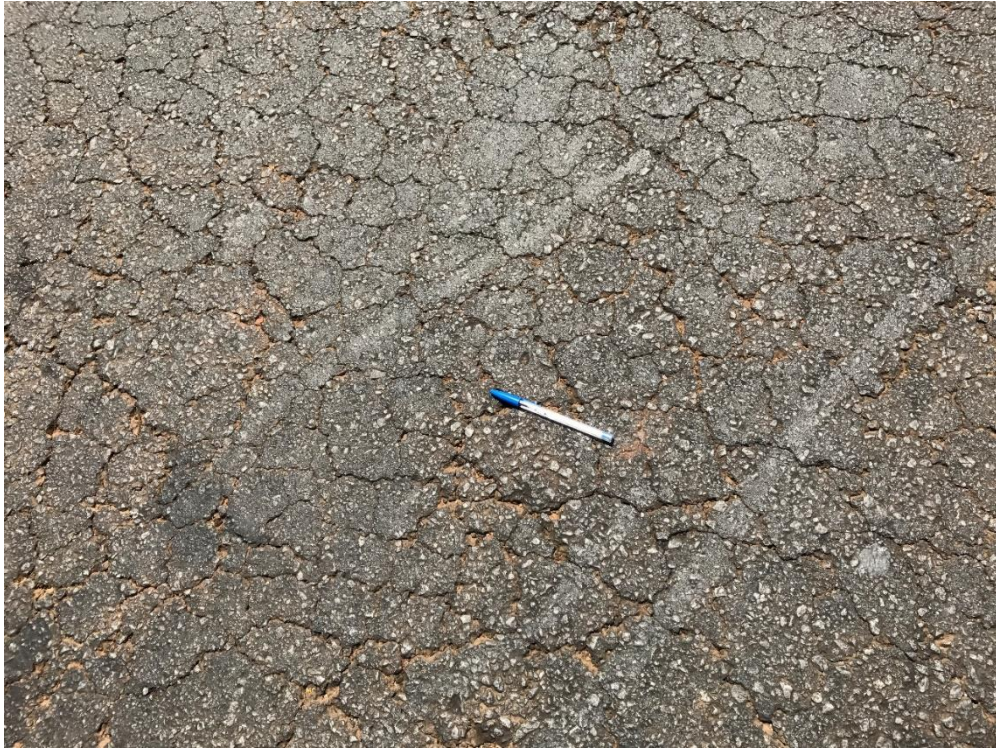
Figura 38 - Trinca couro de jacaré
