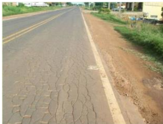
Figura 24 - Trincas de bordo
