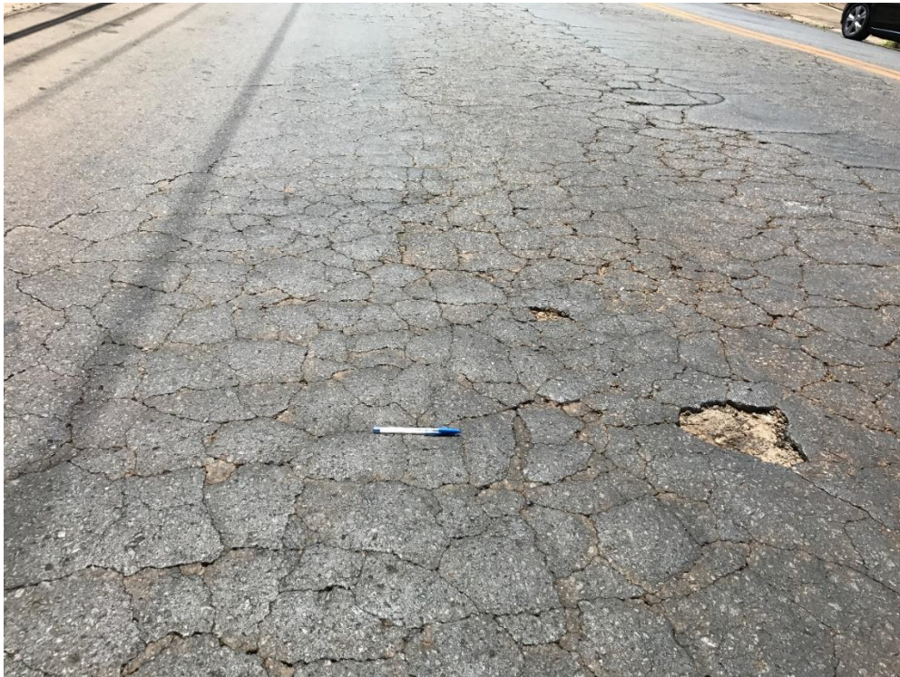
Figura 39 - Trinca couro de jacaré
