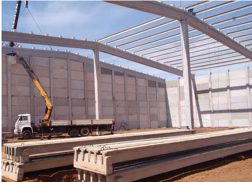
Figura 1- Galpão com pilares, vigas de cobertura, terças e fechamento em painéis pré-fabricados
