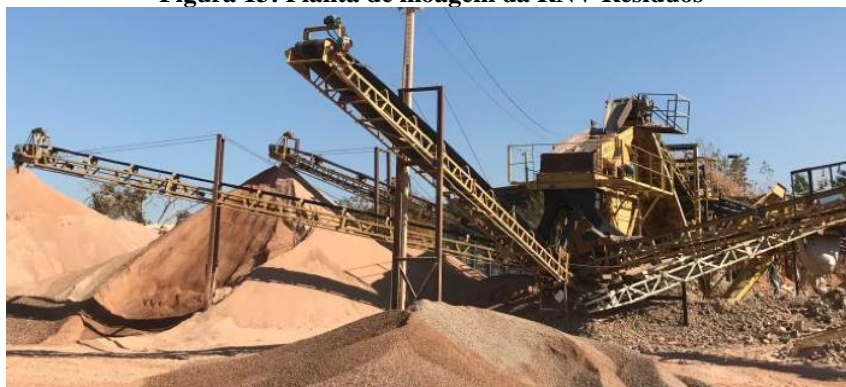
Figura 13: Planta de moagem da RNV Resíduos
