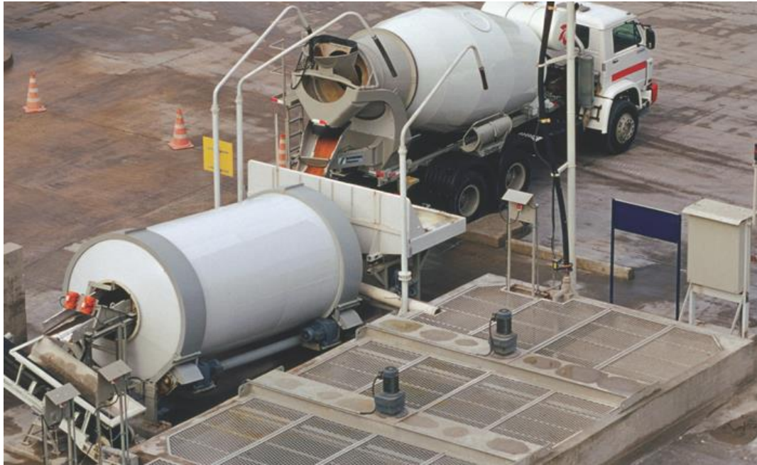
Figura 2 - Unidade recicladora de concreto fresco
