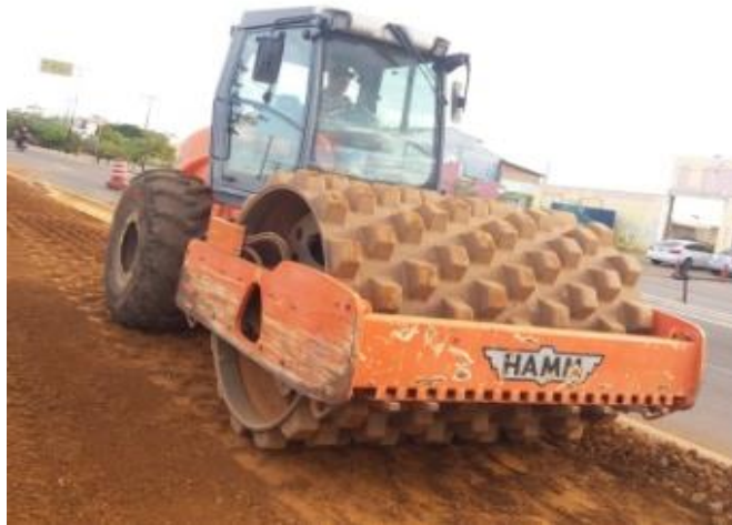
Figura 12 - Rolo pé de carneiro
