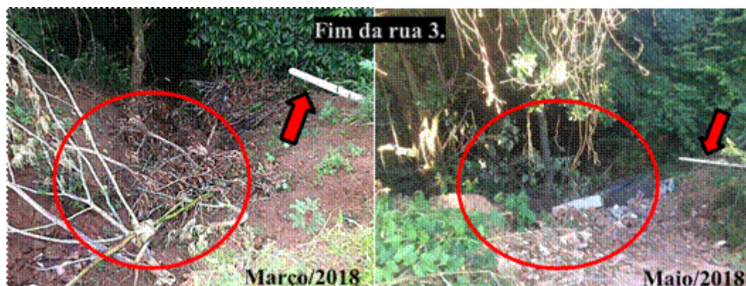
Figura 19 – Formação de processo erosivo e lançamento de água pluvial
