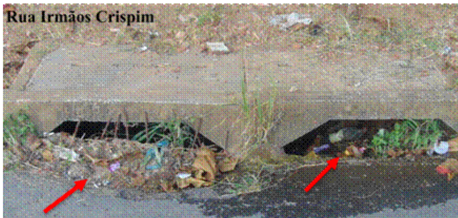
Figura 11 – Resíduos sólidos nas infraestruturas de captação das águas pluviais
