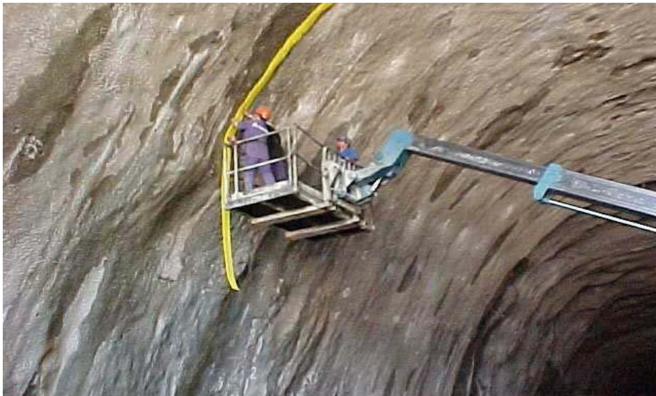
Figura 16– Geossintético no revestimento de um túnel
