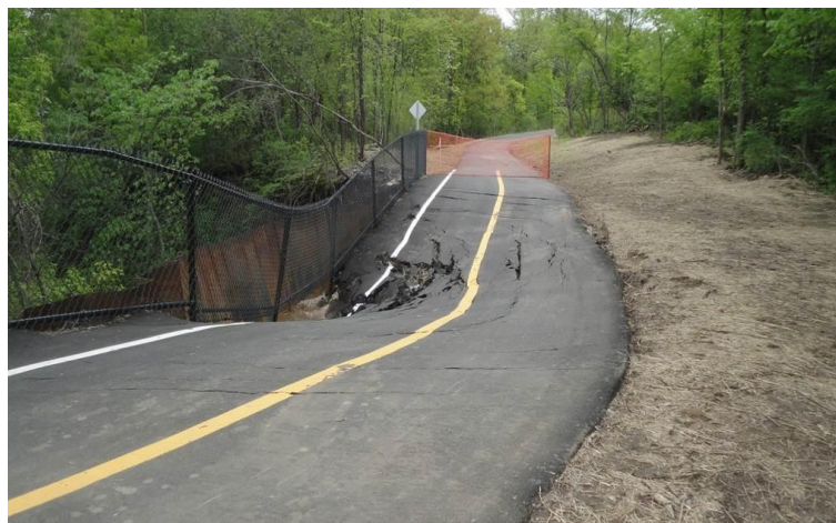
Figura 20 – Falha ou inexistência do sistema drenante de rodovia
