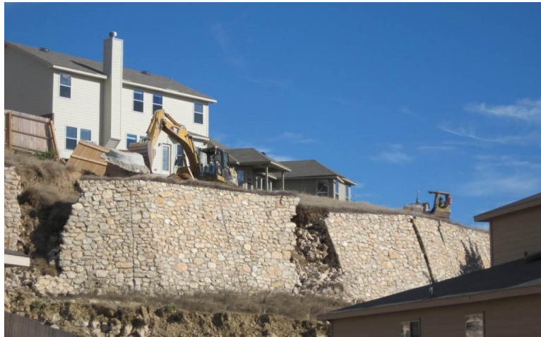
Figura 19 – Falha do sistema drenante do muro de contenção
