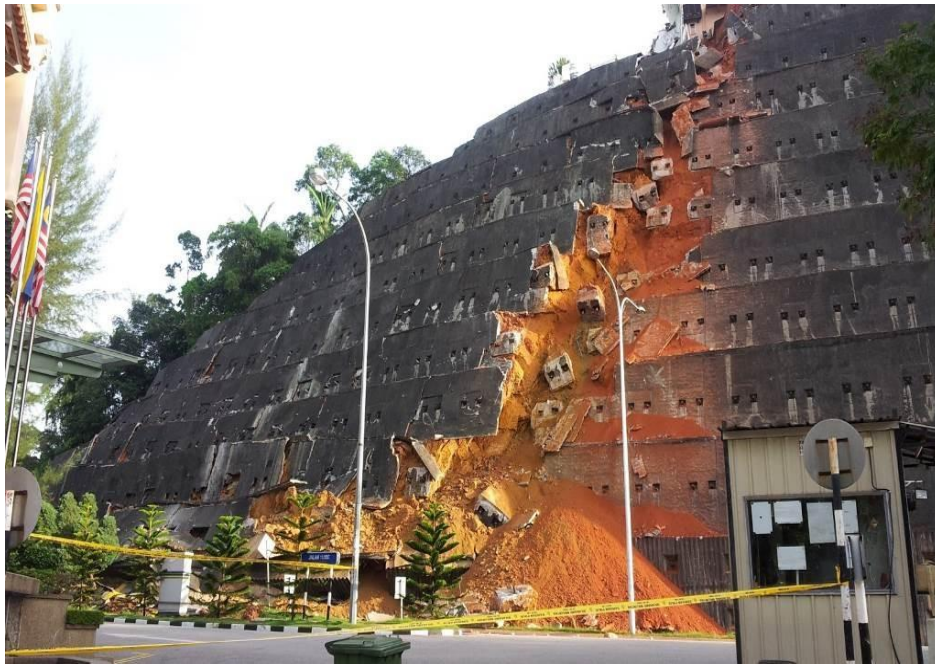
Figura 21 – Ruptura de muro de arrimo: falta de drenagem
