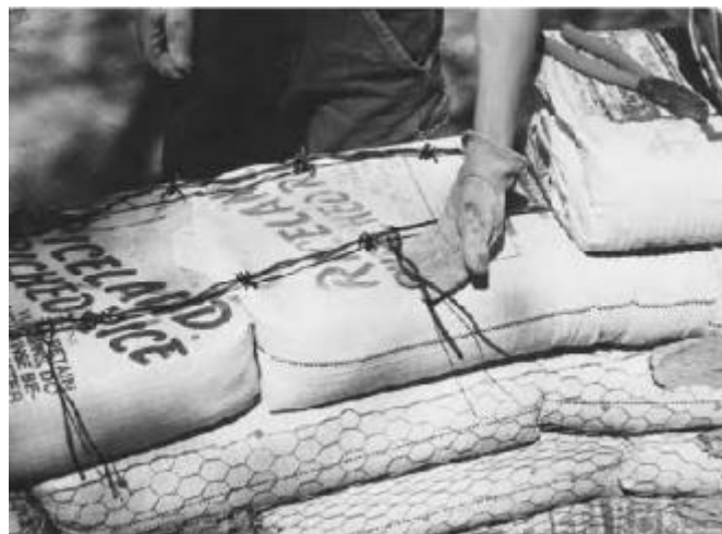
Figura 03 – Tela hexagonal plástica colocada junto aos sacos de superadobe para auxiliar nas instalações hidráulicas e elétricas.
