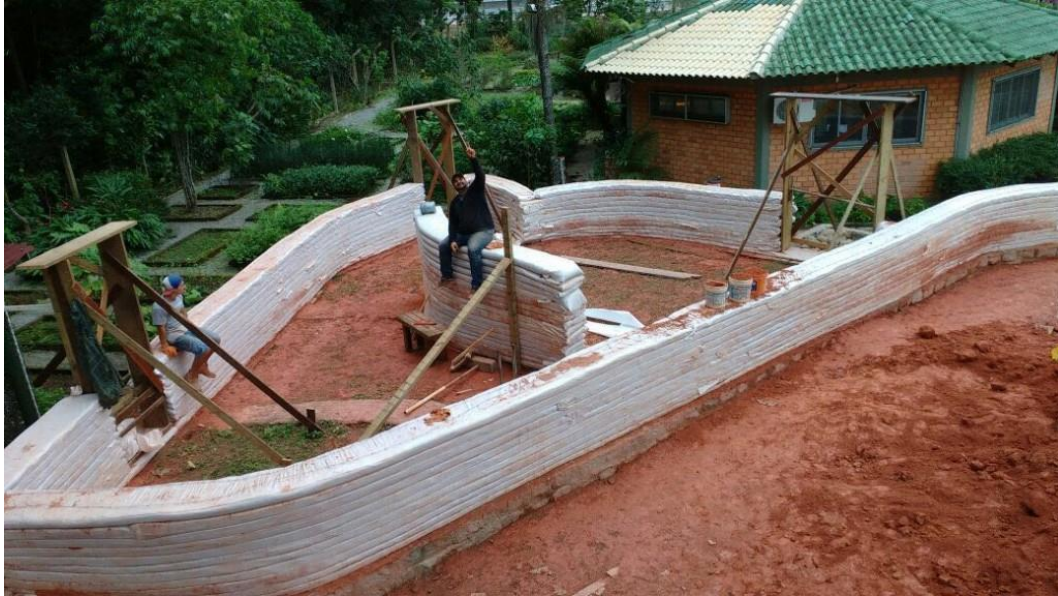
Figura 11 – Construção da uma recepção para a Associação dos Funcionários Fiscais do Estado de Santa Catarina
